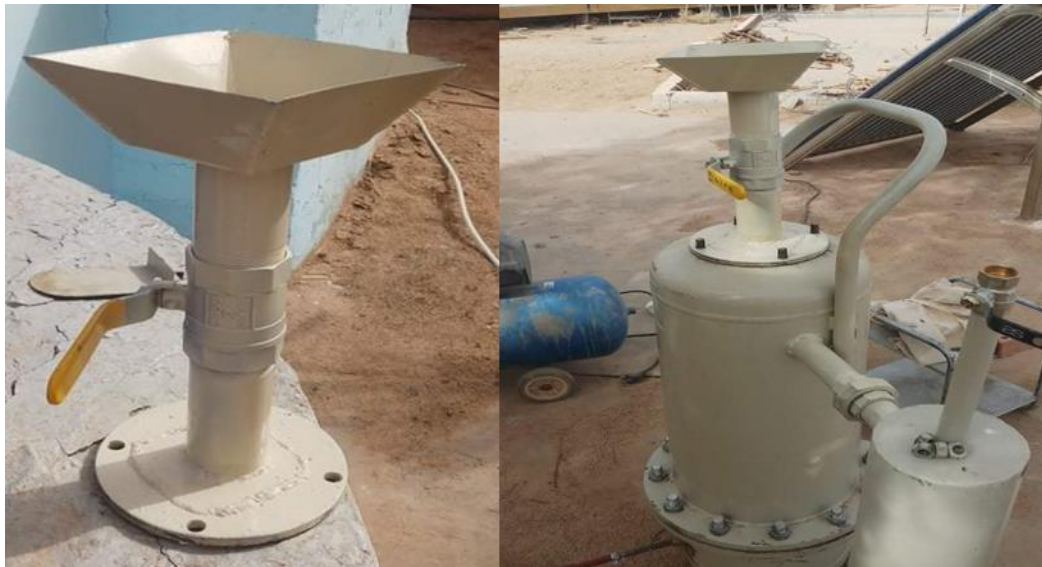
Photo 20: Bac et conduite d'alimentation pour substrat
