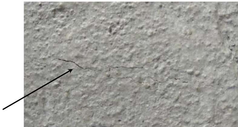
Figure 1.6. Fissures transversales d'âge précoce dans un béton récemment coulé [43]
