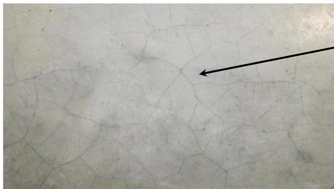
Figure 1.10. Fissures cartographiques apparues dans une dalle de plancher en béton
