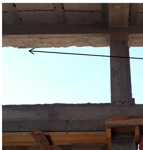
Photo 2.51. Qualité du béton médiocre.
