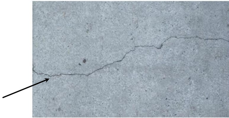
Figure 1.11. Fissure de retrait retenue survenue dans une bordure en béton [43]
