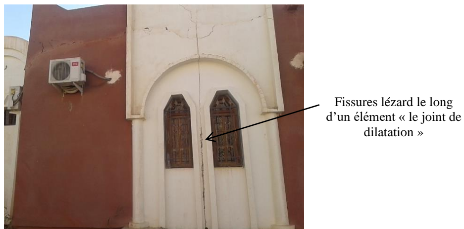
Photo 2.63. Joint de dilatation non matérialisé.
