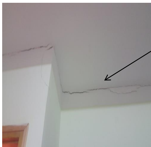
Photo 2.65. Eclatement des enduits.
