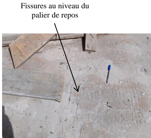
Photo 2.1. Fissures au niveau du palier d'escalier
