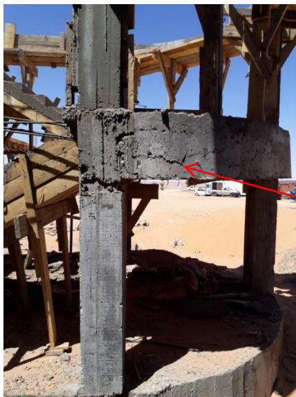
Photo 2.31. Coffrage mal exécuté.
