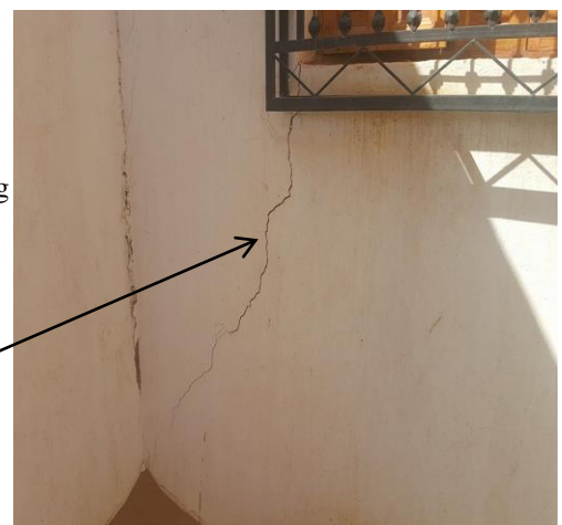
Photo 2.66. Fissure entre appuis.
