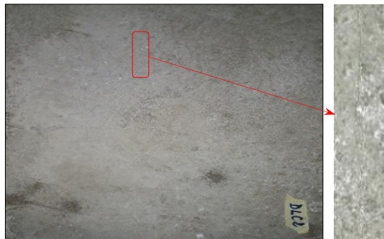
e. Fissures sur dallâtes traitées avec la cure conservées à l'extérieur du laboratoire
