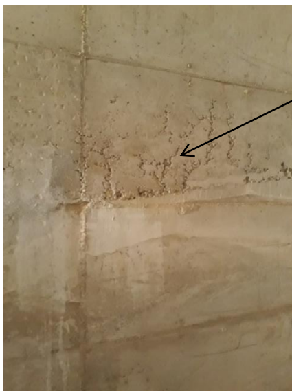
Photo 2.45. Pores sur le mur voile.
