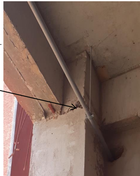
Photo 2.46. Mauvaise jonction de béton.
