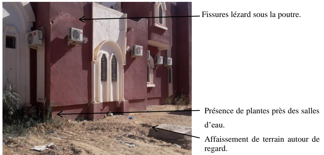
Photo 2.64. Fissures au-dessous de la poutre.
