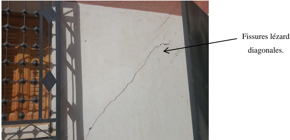
Photo 2.67. Fissure diagonale entre appuis.
