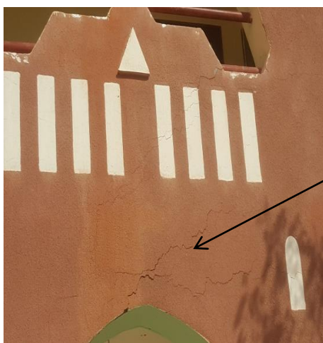
Photo 2.59. Fissuration à l'arcade.
