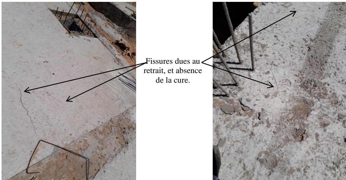
Photo 2.35. Retrait apparent à la plateforme. Photo 2.36. Absence de la cure source des fissures
