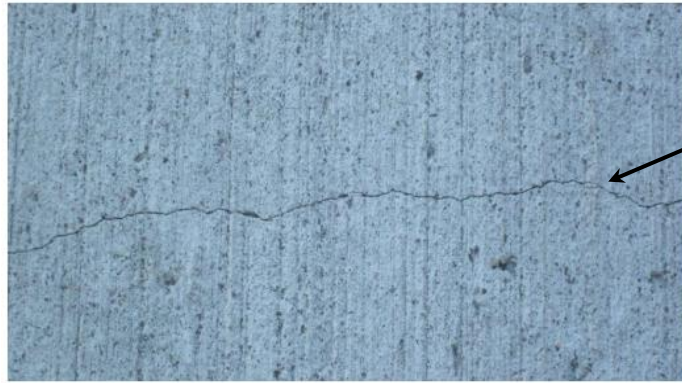
Figure 1.7. Fissure transversale de début d'âge dans une dalle de chaussée en béton.
