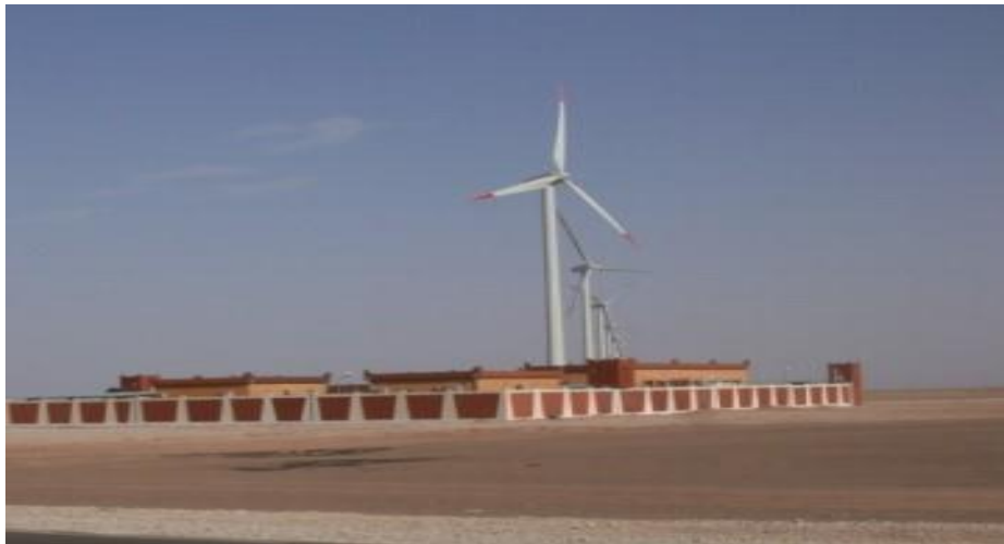
Figure (I.5). Ferme Eolienne de 10MW à Kabertène (ADRAR) [3].
