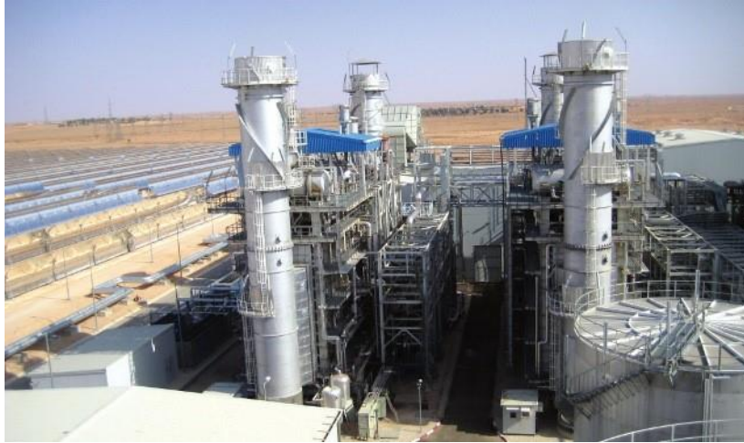
Figure (I.4). Centrale Hybride Solaire-Gaz de 150 MW à Hassi R'mel (Laghouat) [3].
