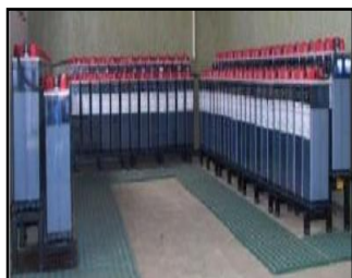
Banc de batteries
