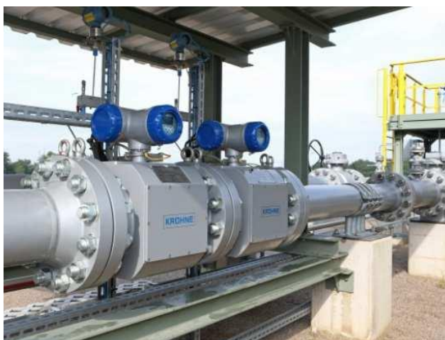
Figure 4.1 -Skid de comptage de gaz de « GTIM »
