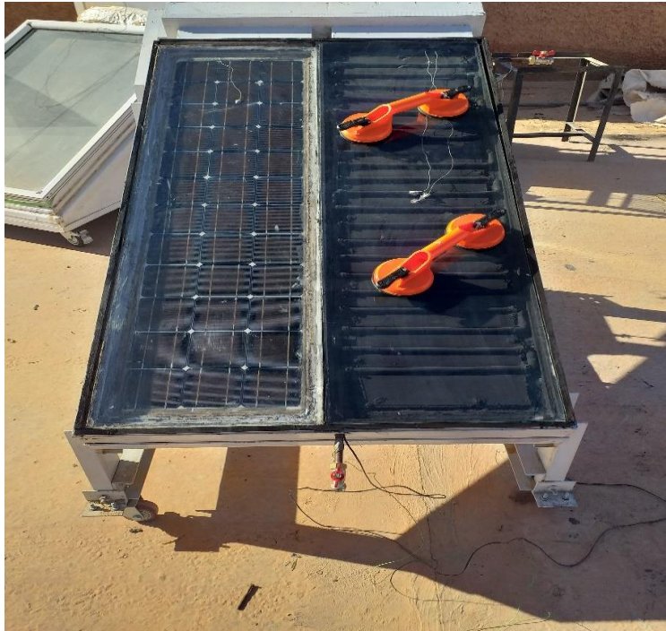
Figure V.13. Image représentant l'emplacement du vitrage sur les capteurs solaires
