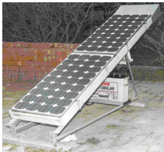
Figure I.17. Image de l'installation expérimentale du capteur hybride PV/T à air, réalisé à New Delhi (Inde) [14].
