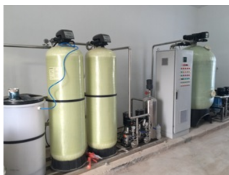
FIGURE 3.15 – Station de traitement d'eau
