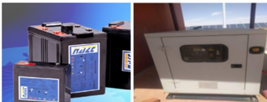
FIGURE 3.13 – Groupe diesel et batteries utilisés
