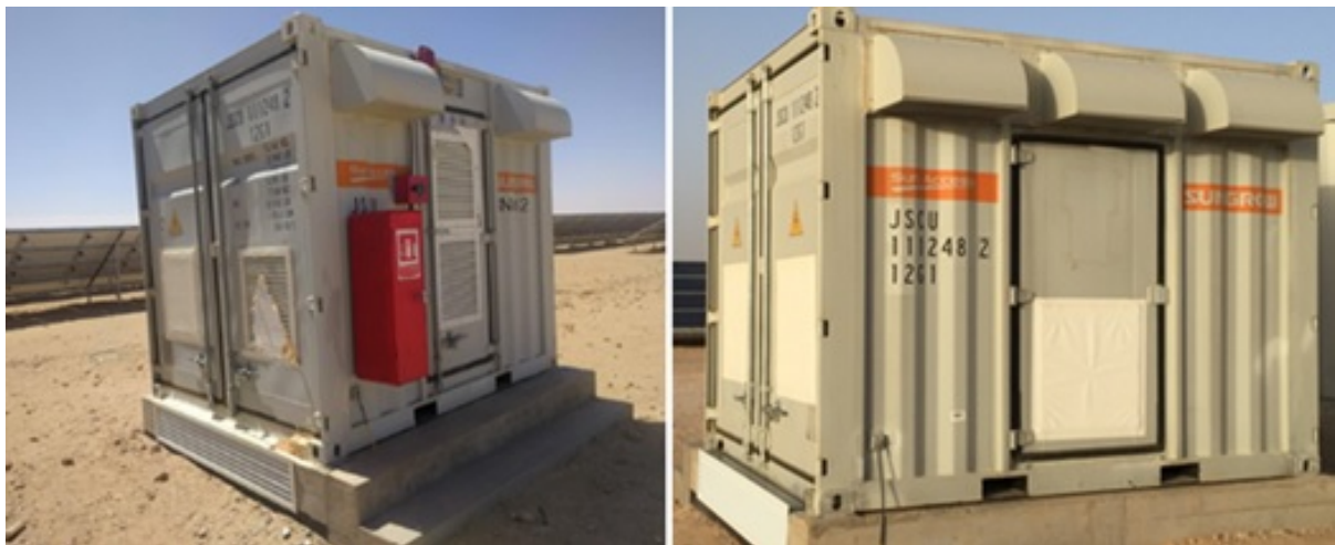
FIGURE 3.9 – Local de l'onduleur (Shelter)
