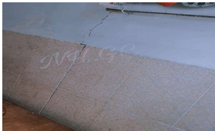
Fig. III.5 : Fissure verticale sur mur cloison.
