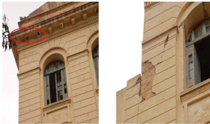
Fig. I.27 : a) Dégradation des éléments décoratifs de plâtre. b) Décollement par plaques des enduits.
