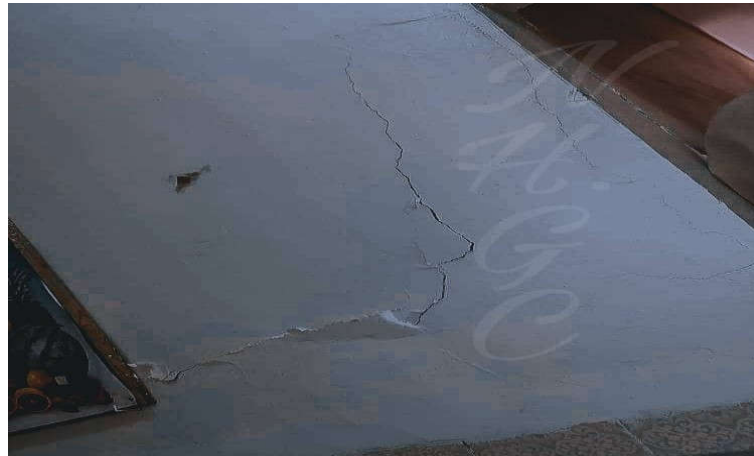
Fig. III.6 : Fissure des enduits sur mur cloison
