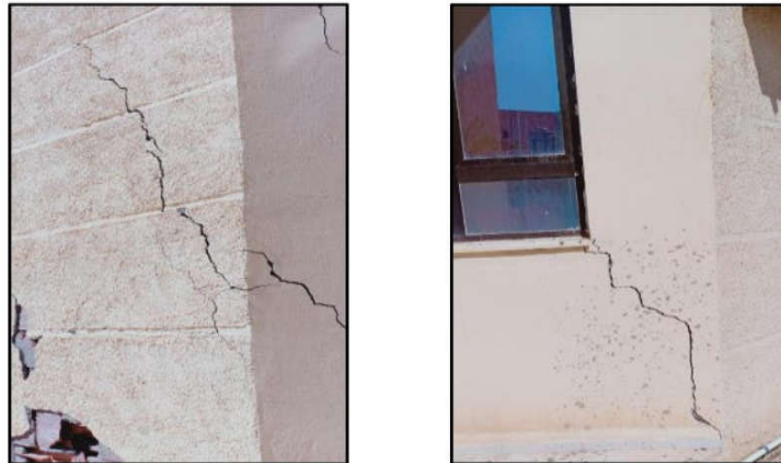
Fig. I.10 : Des fissures inclinées sur les murs.
