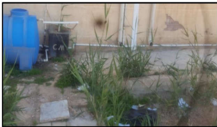
Fig. I.11 : Apparition de végétations (indice de longue période d'infiltration d'eau).
