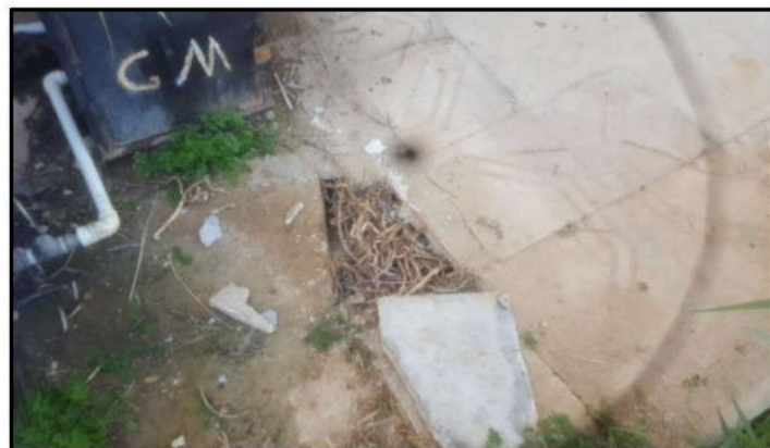
Fig. I.12 : Les racines des arbres et les plantes ont provoqués l'éclatement et gonflement des carrelages
