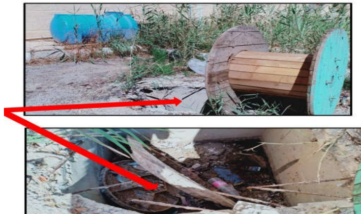
Fig. I.14 : Dégradation d'un regard des eaux usées.
