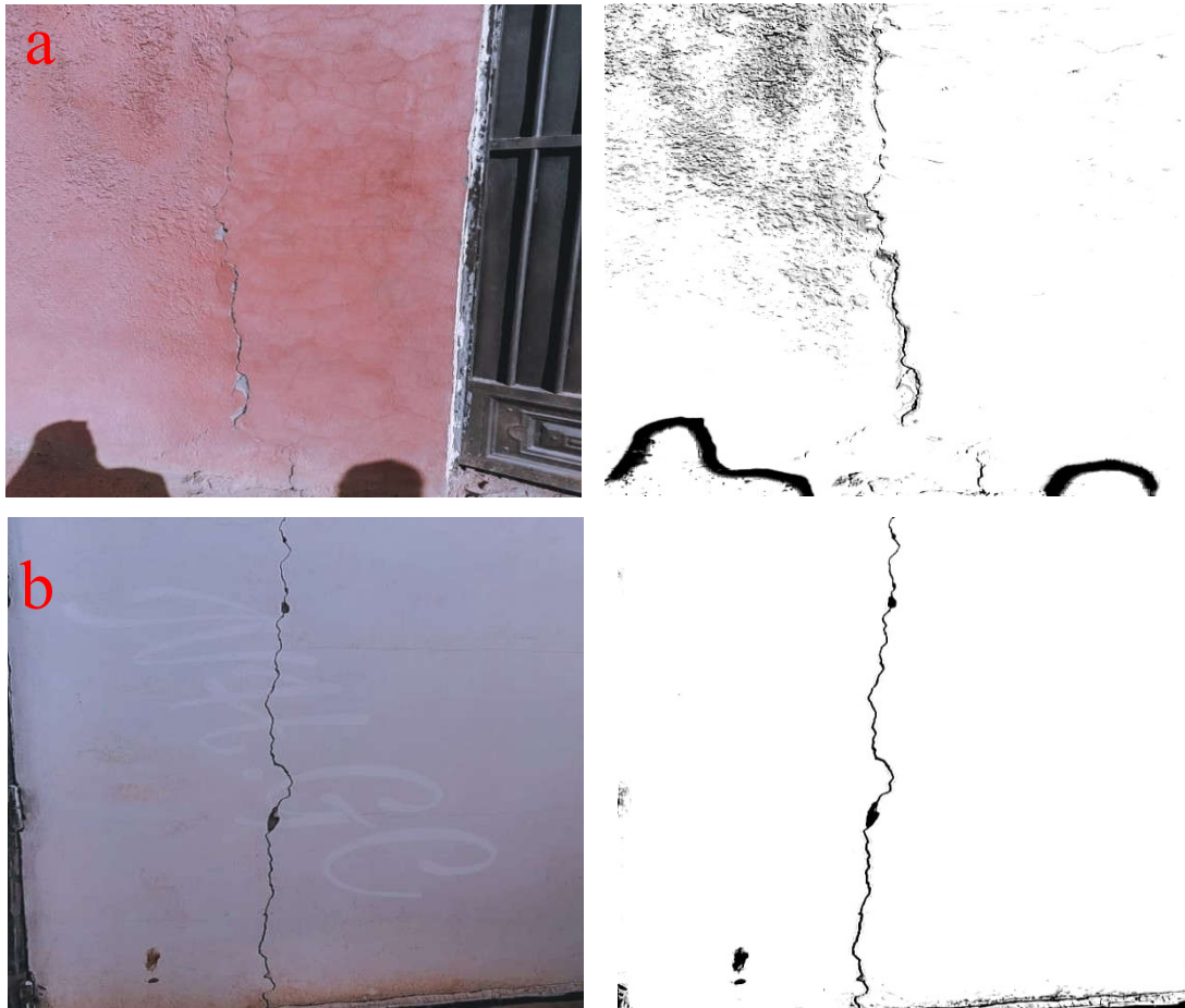
Fig. II.13: Fissures des murs clôture.
