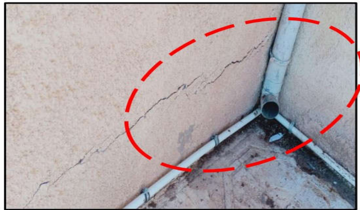
Fig. I.13 : L'existence d'une crevasse sous et à côté d'une conduite d'eau pluviale.
