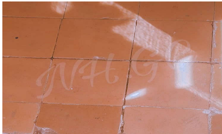
Fig. III.9 : Gonflement et fissure de carrelage.
