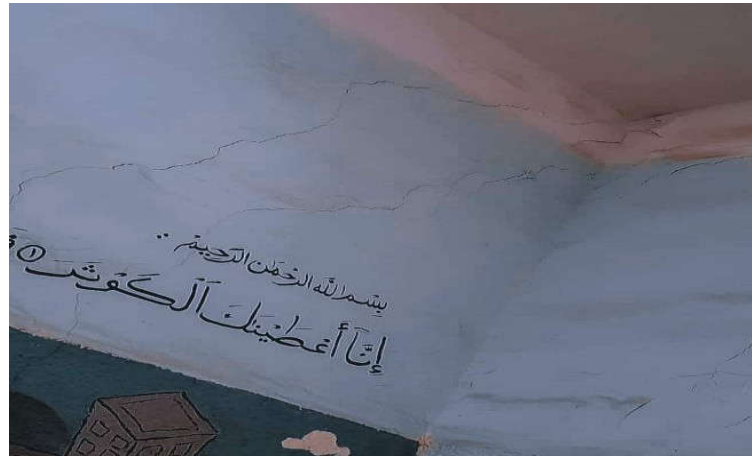
Fig. III.4 : Des fissures diagonales du revêtement.
