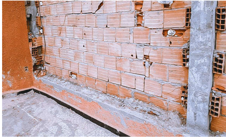
Fig. II.21 : Le dégât de mur maçonnerie au niveau de la brique.
