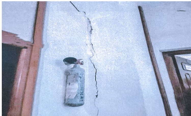
Fig. II.20: Fissuration verticale au niveau de mur cloison.
