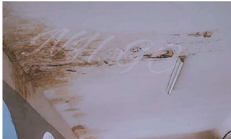
Fig. III.12 : Les taches de rouille.
