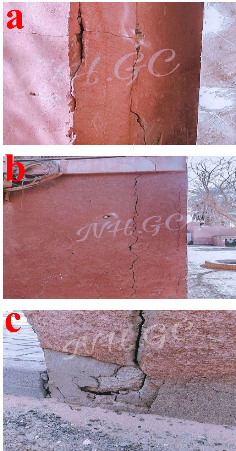
Figure III.8 : Des fissures profondes avec éclatement sur les poteaux.
