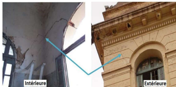
Fig. I.22 : Fissures profond (le dernier étage).
