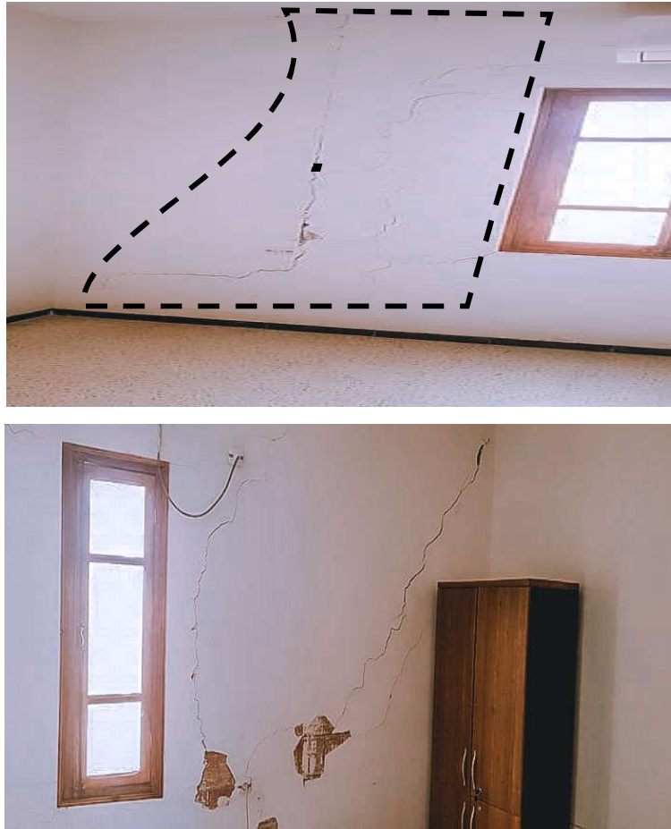
Fig. II.9: Les photos représentant une partie des dégâts du bâtiment.
