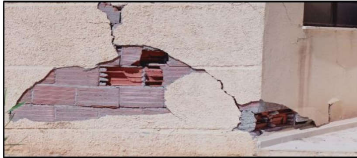
Fig. I.9 : Éclatement de mur en maçonnerie
