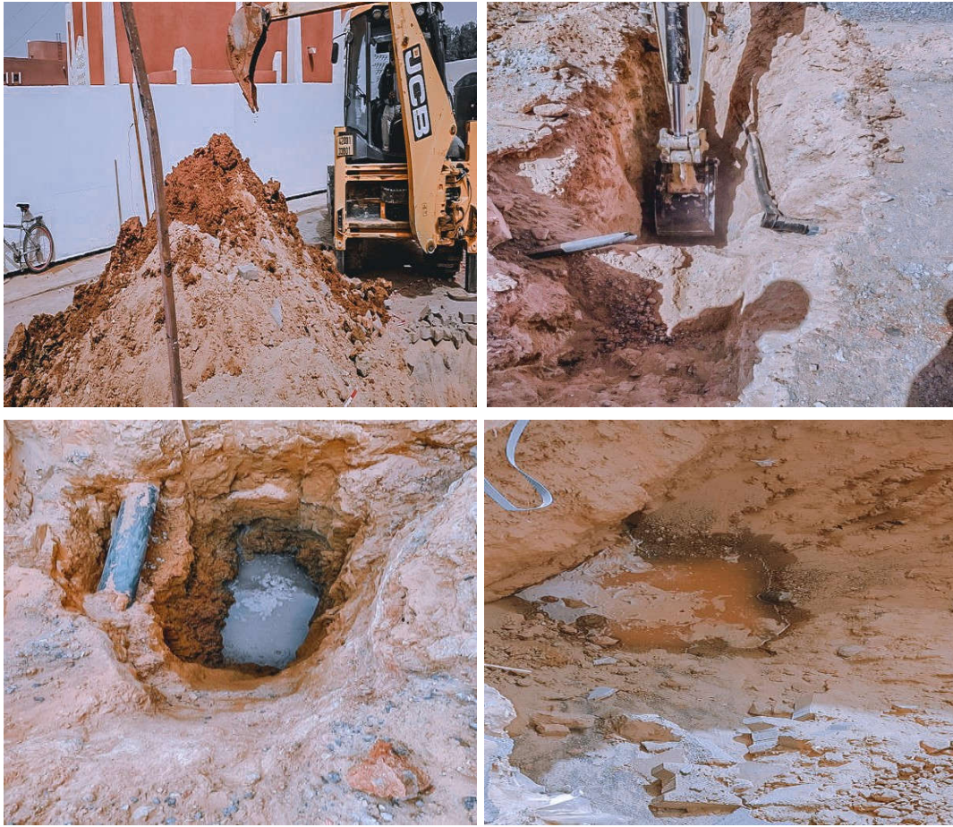
Fig. II.10 : Photos montrant des fuites d'eau sur le site.
