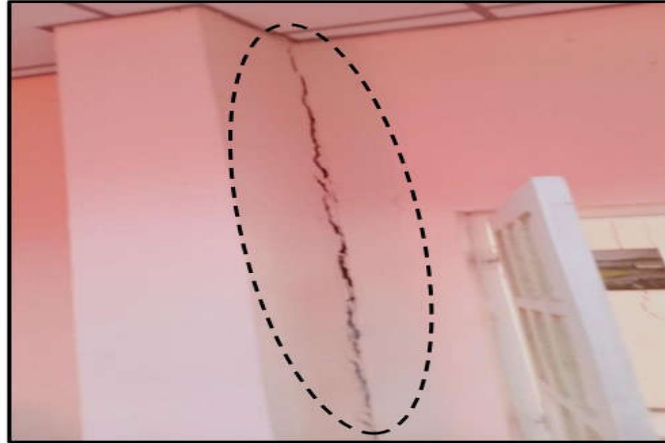
Fig. I.15 : Fissuration verticale au niveau des murs cloisons provoquant leur décollement du poteau.
