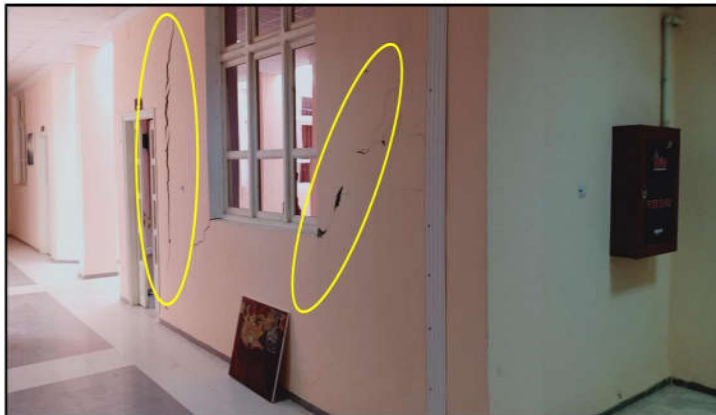
Fig. I.19 : Détérioration des cloisons du Hall.
