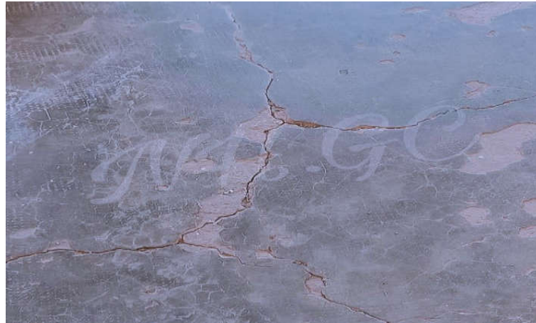
Fissure III.10: Détérioration du sol en béton.
