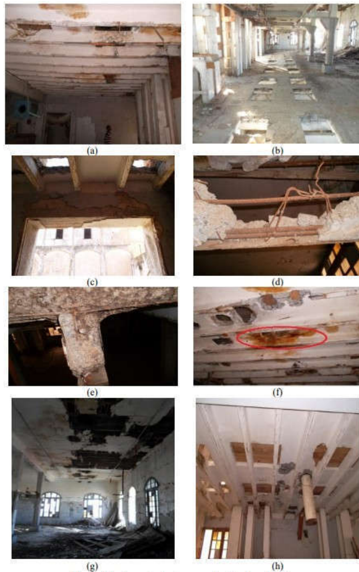
Fig. I.26 : Les pathologies constatées dans les planchers
