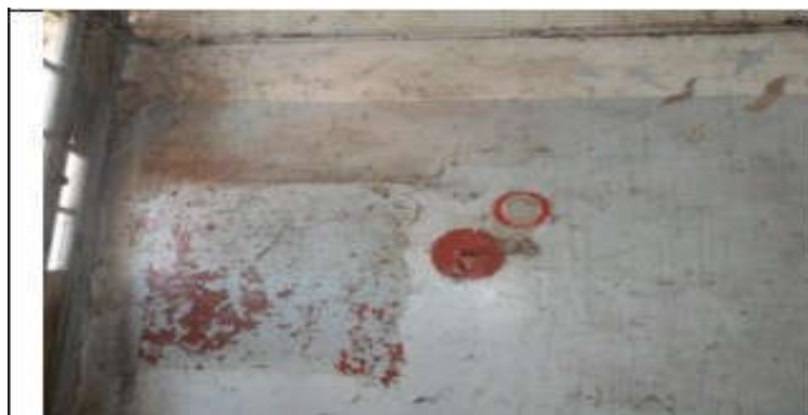
Fig. I.23 : Fissure superficielle en diagonale 45°.
