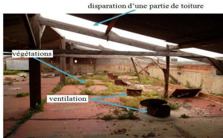
Fig I.29 : L'état de la terrasse.
