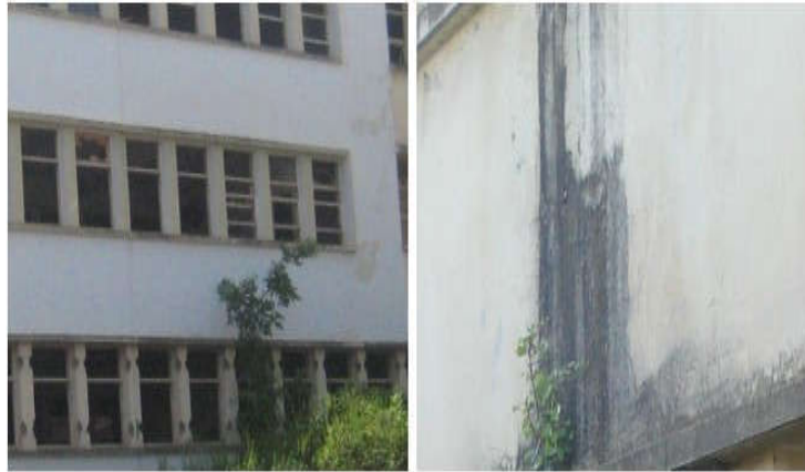
Fig. I.34 : a) Humidité aux niveaux des tuyaux d'évacuation des eaux pluviales b) Menuiseries en mauvais état.
