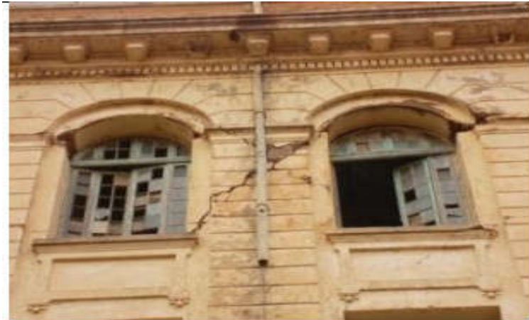
Fig. I.24 : Fissure en double diagonales (crois) due au mouvement sismique
