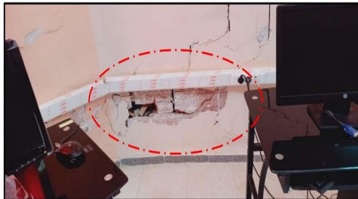
Fig. I.17 : Décollement de l'enduit et éclatement d'une partie d'un mur dû à un tassement différentiel.
