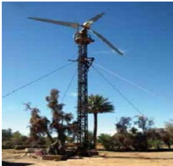
Figure I.3 : première éolienne installée en Algérie [11].
