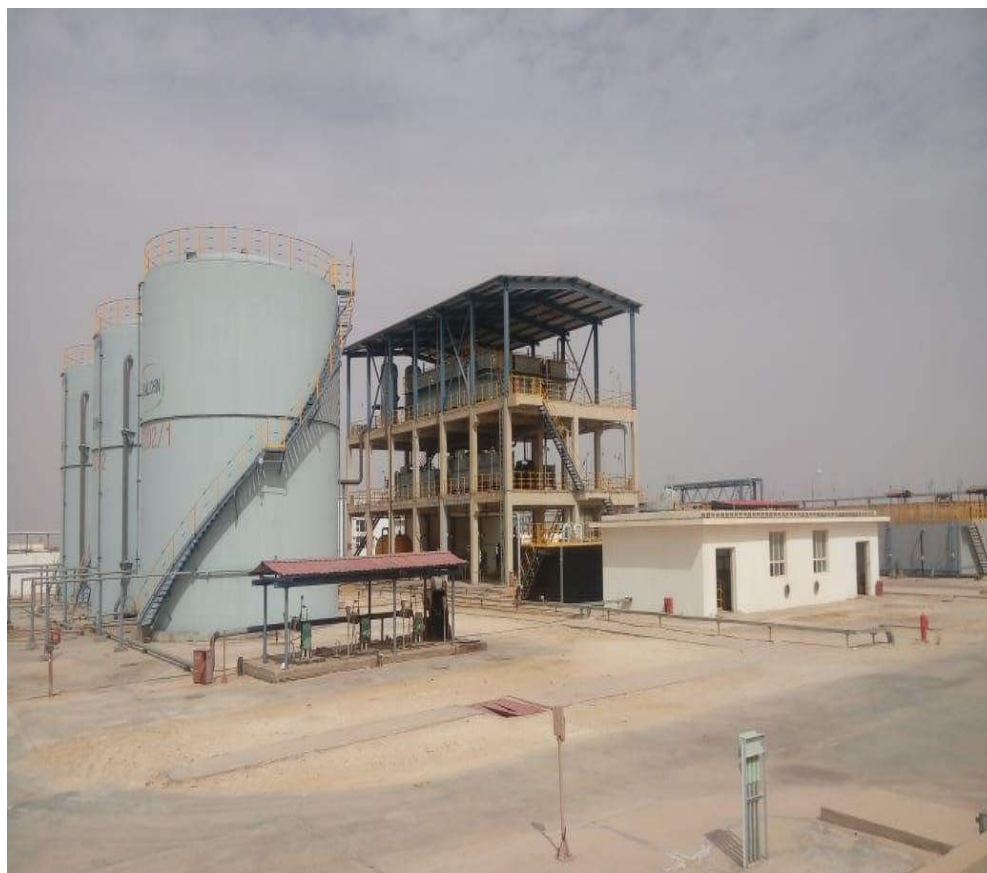
Figure .III.9 : Photo d'unité du traitement des eaux usées.
