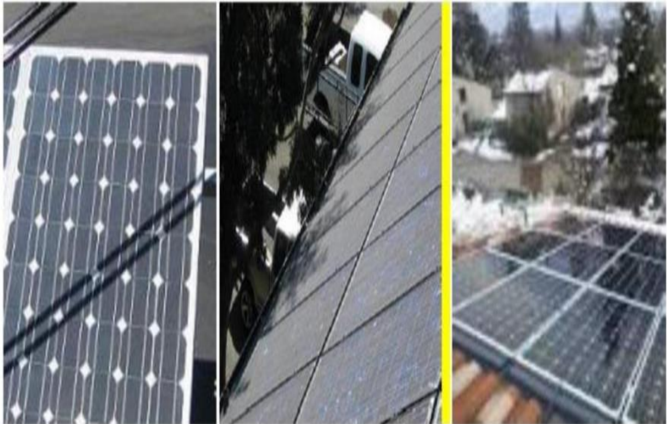
Figure II.2: Défaut d'ombrage partiel [10].
