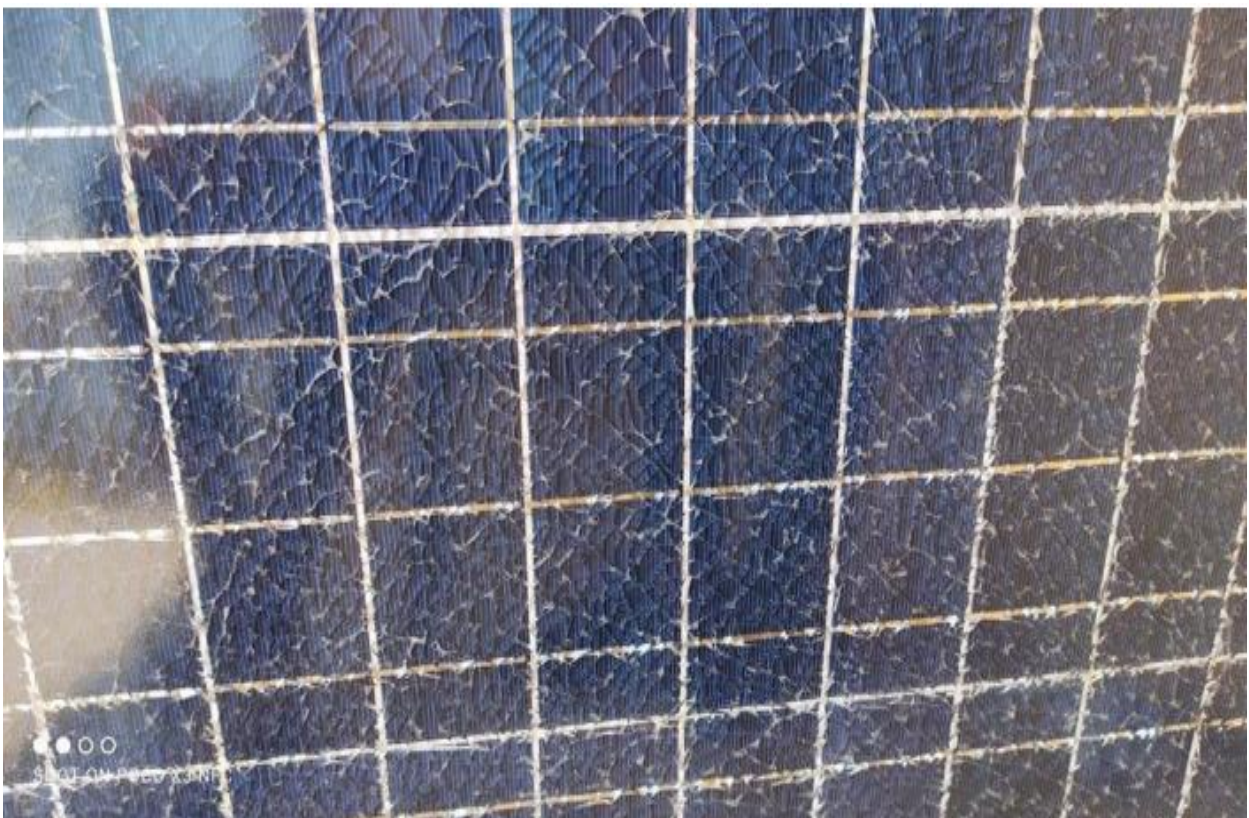
Figure III.5: Bris du verre de la face avant.
