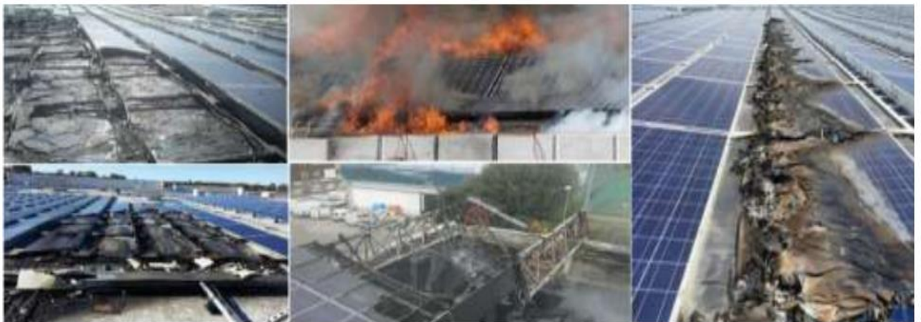
Figure II.1: Dommages causés par des défauts [29].
