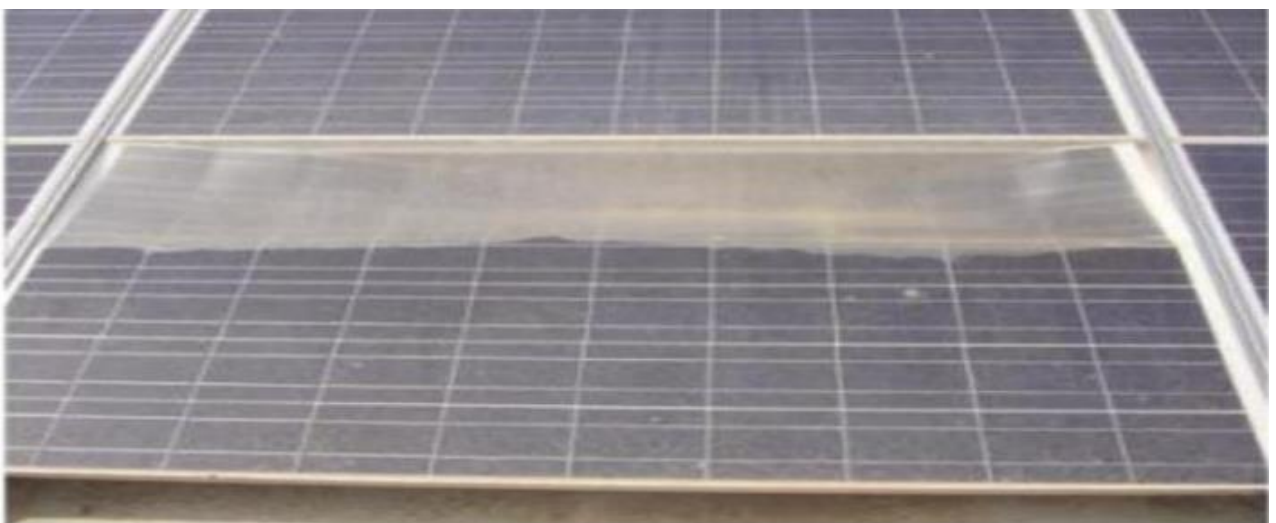
Figure II.9: Défaut de délaminage[10].
