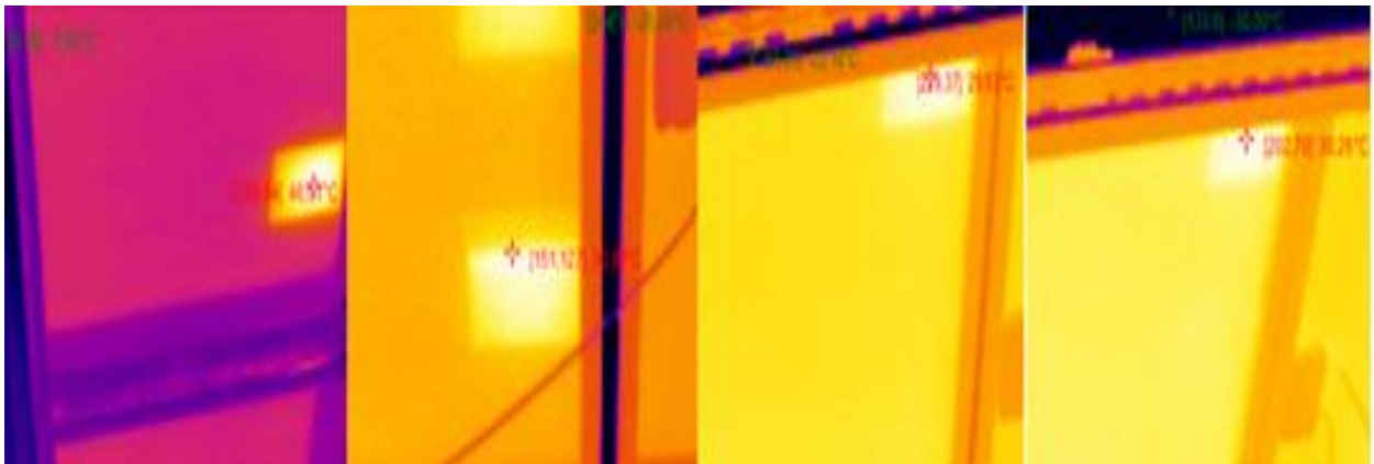
Figure III.33: points chaud au niveau des panneaux sous champ06.
