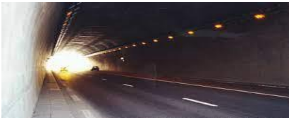
Figure I.16: Tunnel de Cornil (RN 89 - Corrèze) L'éclairage de renforcement d'entrée d'un sens joue le rôle de renforcement de sortie pour l'autre sens [14].
