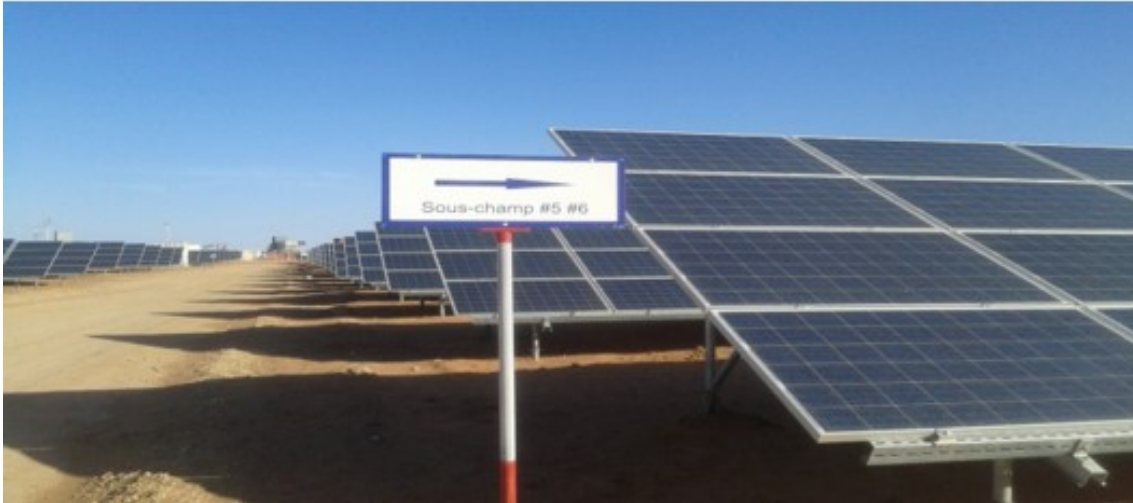
FIGURE 2.2 – Panneaux solaires photovoltaïques de la centrale
