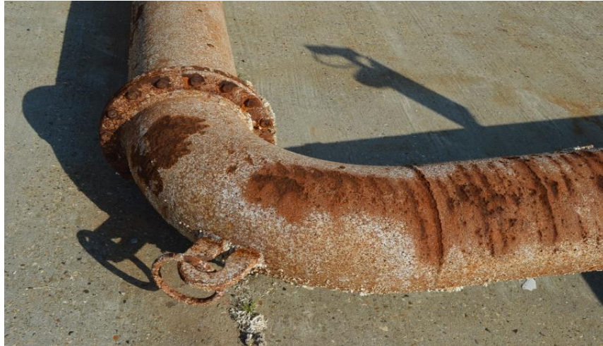
Figure 06 : la corrosion des métaux par l'eau. (Anonyme 4)
