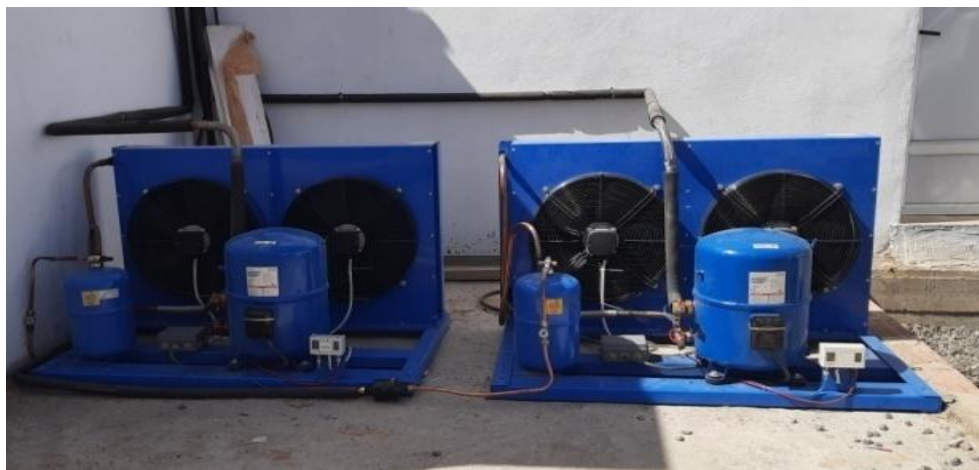
Unité extérieure de climatiseur
