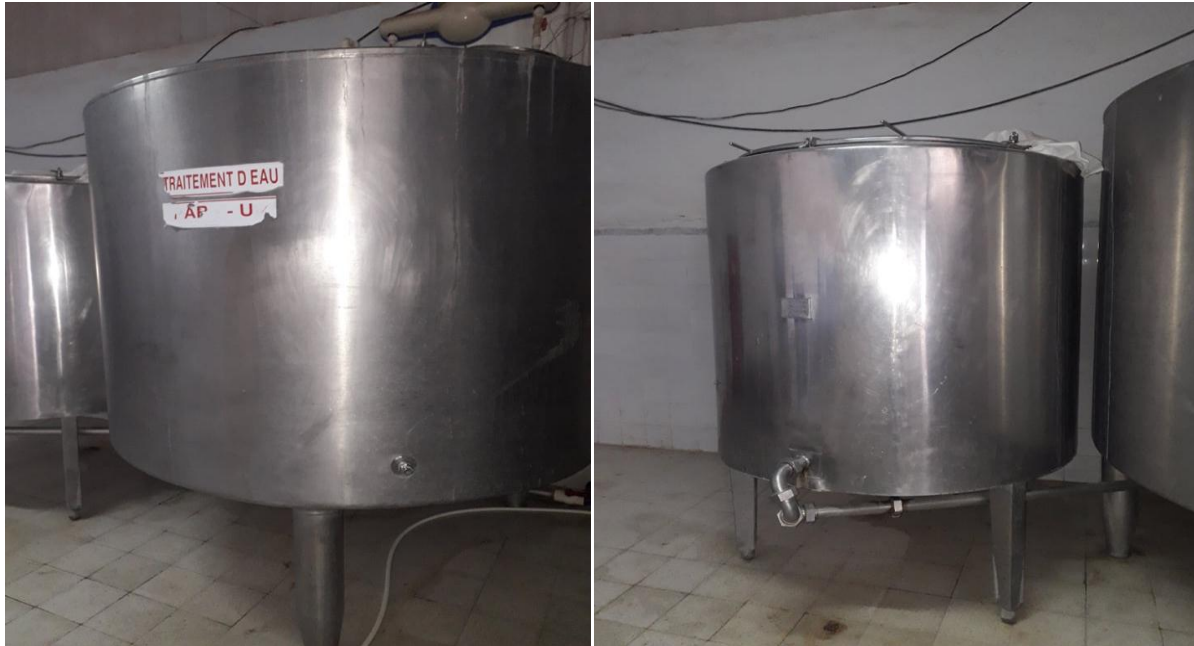
Figure 6: Réservoir de stockage d'eau
