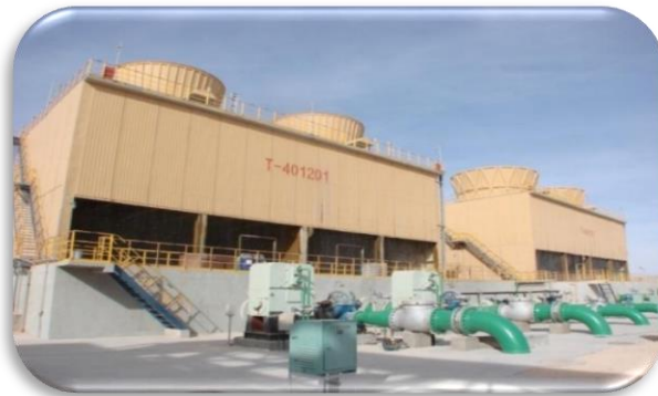
Figure I.13: Tour de refroidissement d'eau
