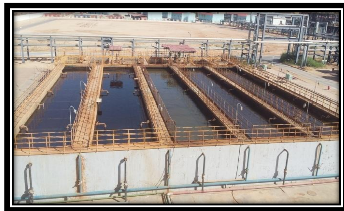
Figure I.14: Bassin de traitement des eaux usées
