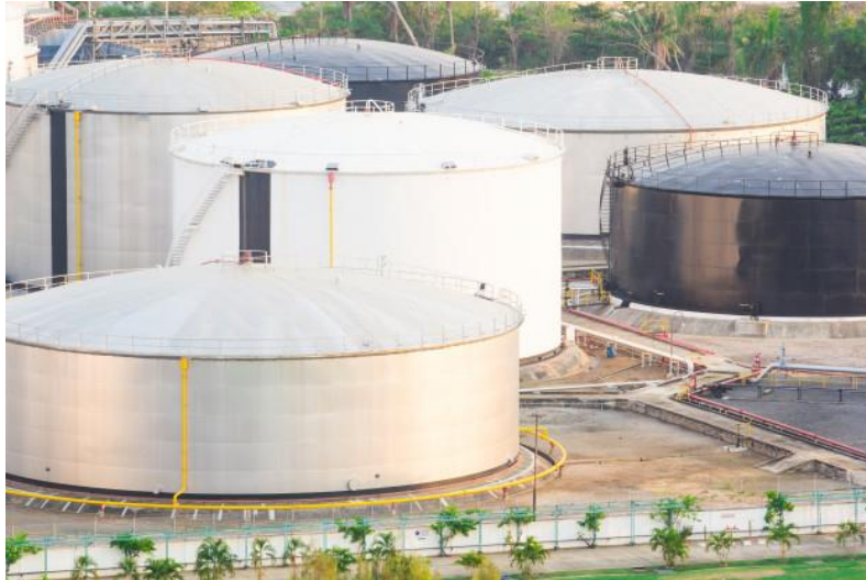
Figure II.22: Bacs à toit fixe
