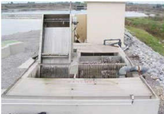
Photo II.2 le prétraitement eaux usées
