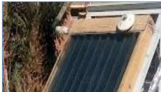
Figure V. 41 : Photo représentant le pyranomètre installé sur le plan du capteur au niveau de la plate-forme des essais de l'URER/MS
