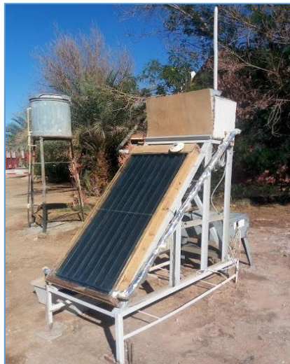
Figure V. 36 : Photo représentant le capteur solaire installé sur la plate-forme des essais de l'URER/MS
