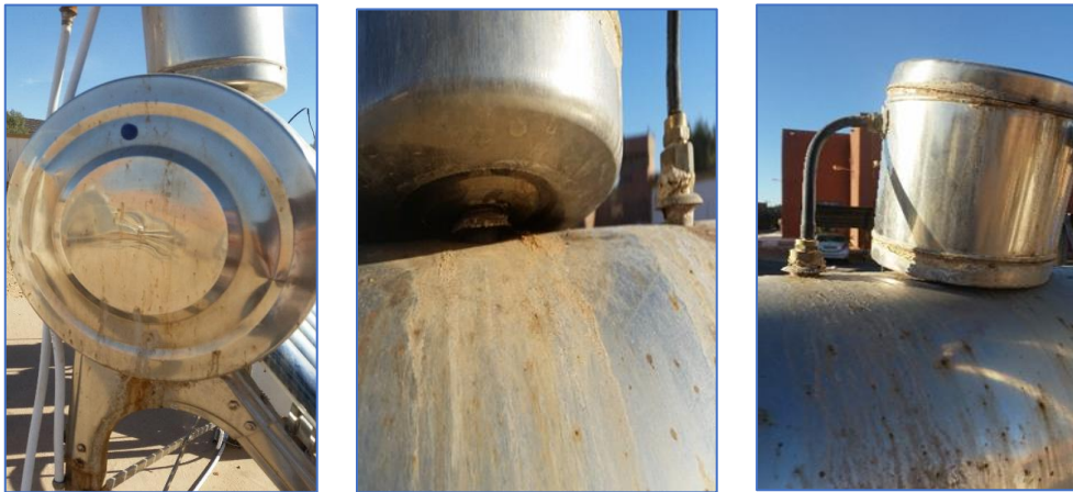
Figure II. 34: Dégradation d'un capteur sous vide dû ou longue exposition et température de stagnation élevée.
