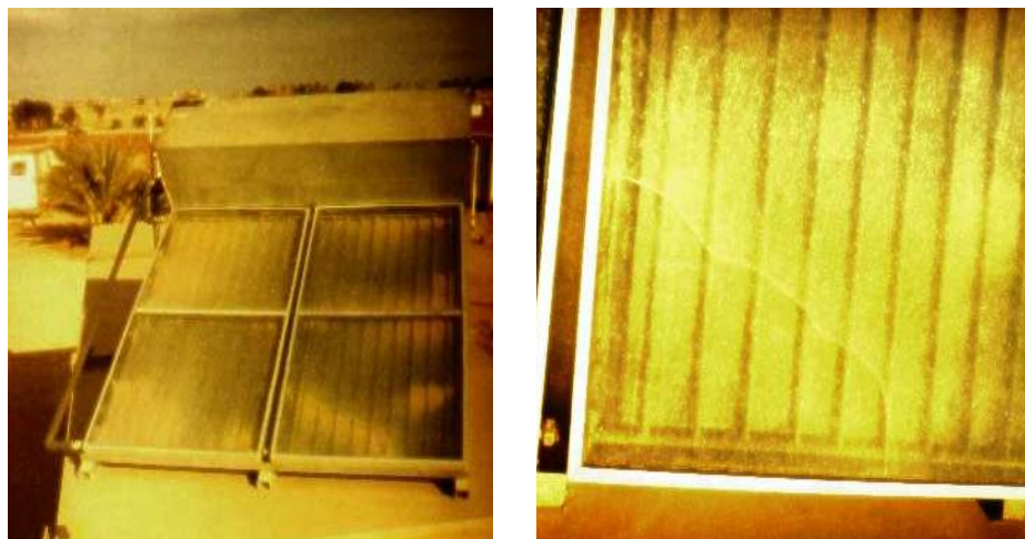
Figure II. 32: Dégradation et brise de la couverture transparente.
