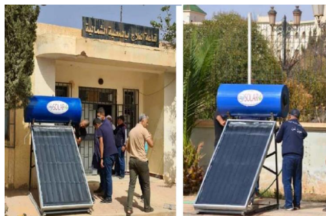
Figure II. 26: Installation des CES dans les établissements publics et les écoles.
