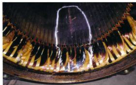
Figure III.2.bobine de générateur avec matériau isolant brulé en raison d'une tensionfluctuante élevée dans le transformateur [4]
