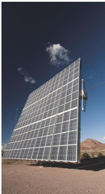
Fig. 2.50 - Système HCPV Amonix. 70 kWc DC (STC). Photo [103].
