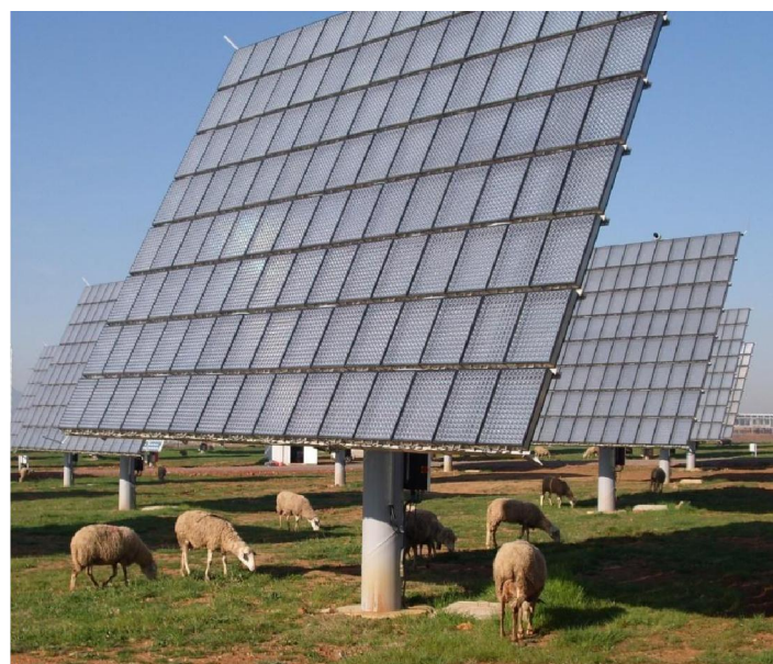
Fig. 2.14 - Centrale solaire CPV. Photo [95].
