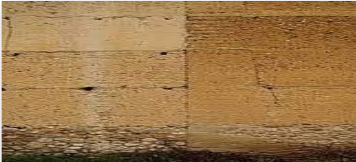
Figure.20 : Mur en pisé [ https://www.google.com
