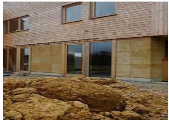
Figure53 : enduit a base de terre crue
