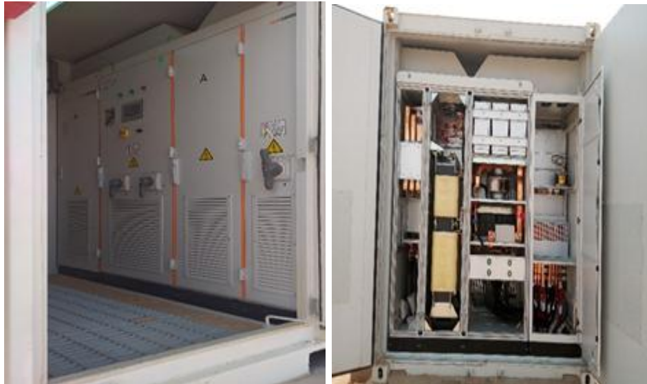
Figure.II.13 : L'intérieur de l'onduleur.
