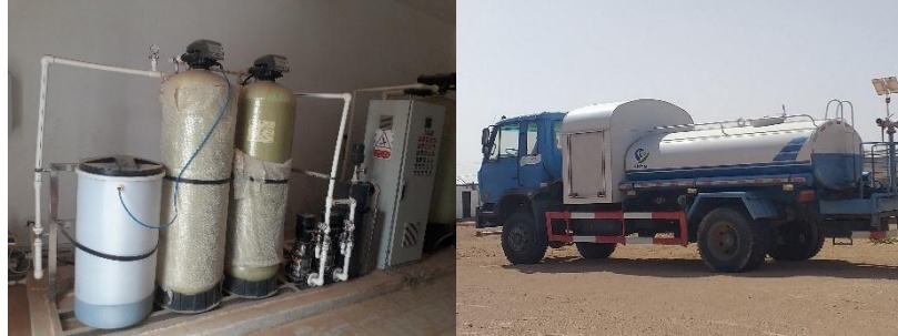
Figure.II.21 : Station de traitement d'eau et équipements de nettoyage.
