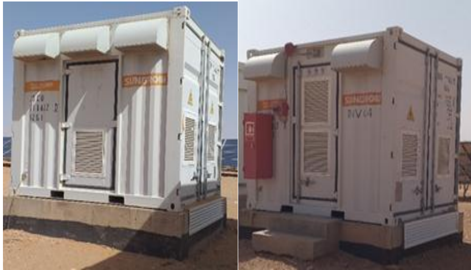
Figure.II.12 : Local de l'onduleur (Shelter).
