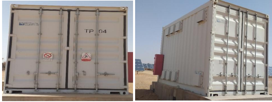
Figure.II.14 : Local du transformateur.
