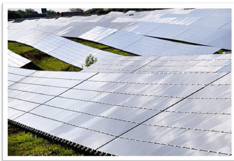
Figure I.1 : des panneaux photovoltaïques [1].
