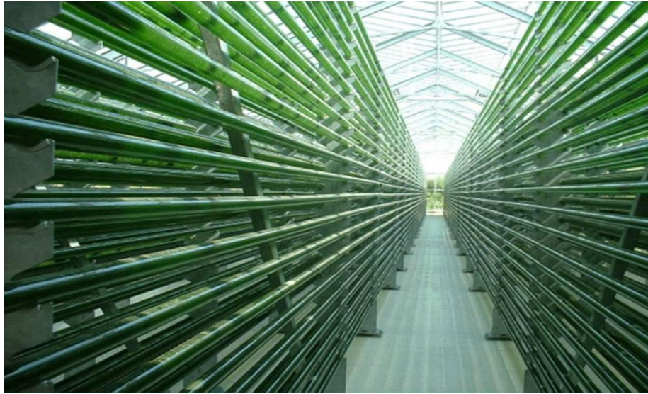
Figure. I.7 : Ouvrage de photo bioréacteur tubulaire (Abdel-Raouf & al. 2012).
