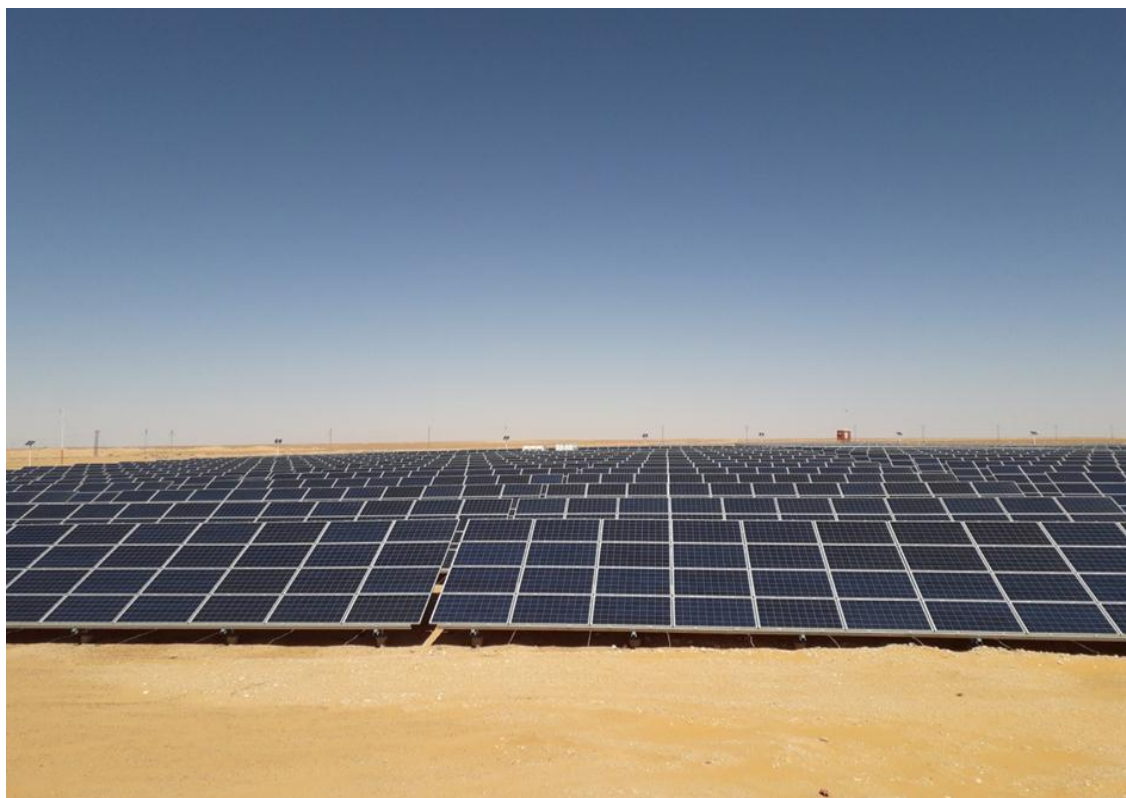
Figure(III-4-a) : Les champs PV de la centrale d'EL-Wajda Timimoune
