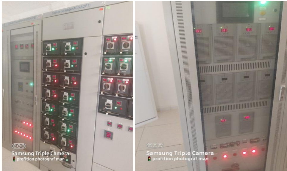
Figure (III-11-b) : LES cellules de comptage et les cellules des batteries
