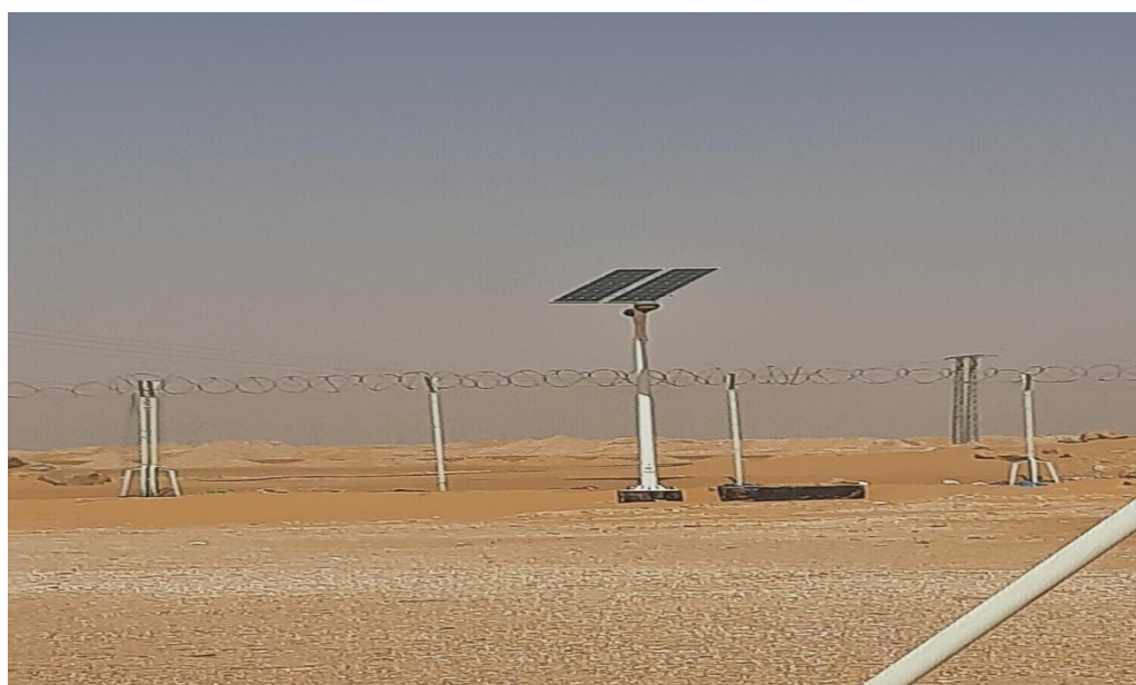
Figure(III-4-b) : Poteaux d'éclairage dans central
