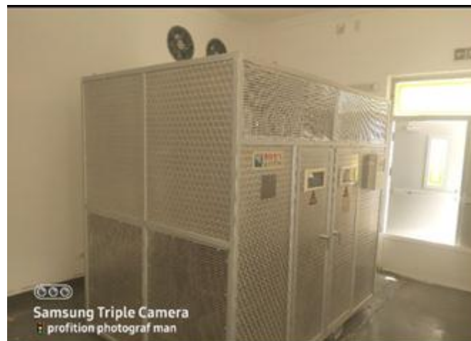
Figure(III-10-b) : Transformateur auxiliaire
