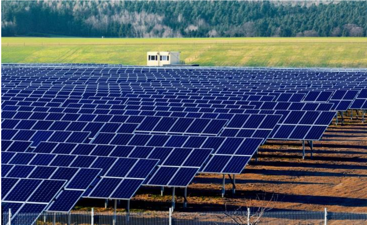
Figure (I-3) : centrale d'énergie photovoltaïque
