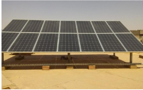
Figure I.1 : Les panneaux photovoltaïques
