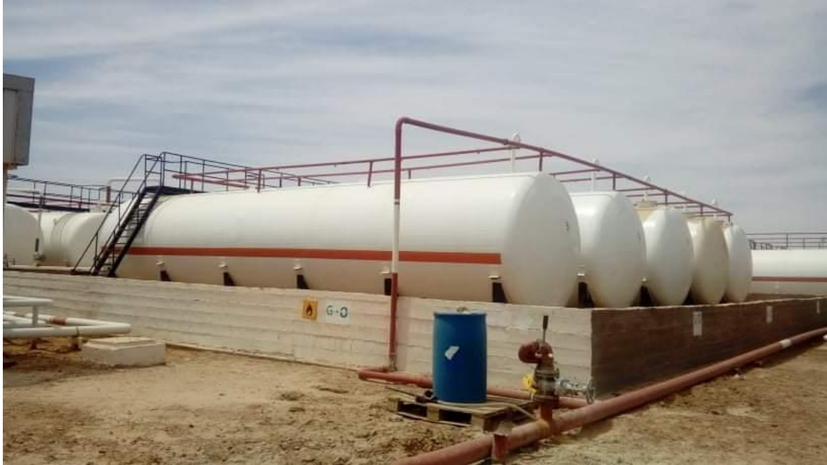
Figure II 7:Cuves pour stockage des produits
