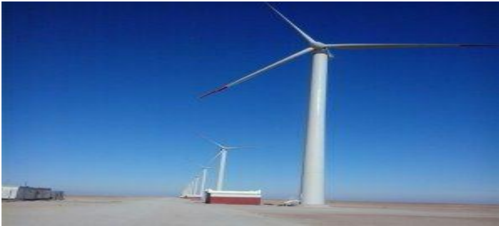
Figure I.9 : 1 er ferme éolienne d'Adrar. [6].
