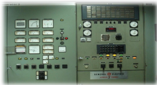
fig.18 Salle de commande
