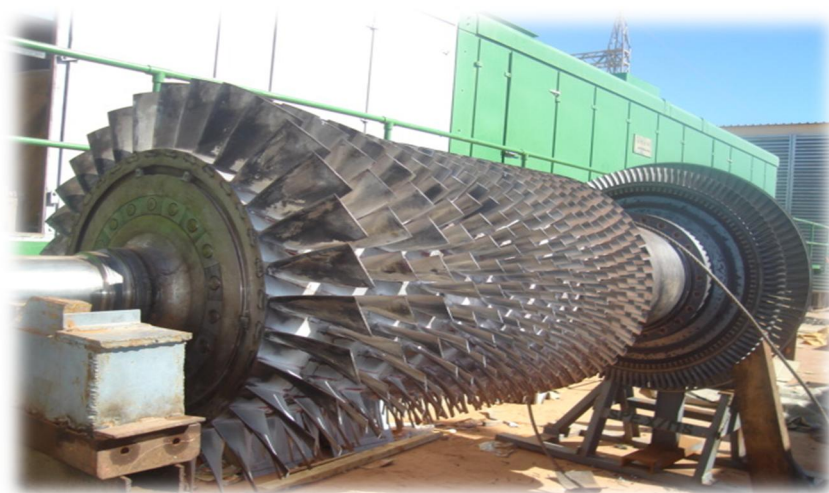
Fig. 4 - Compresseur TG à l'extérieure de la machine
