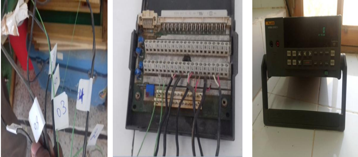
Figure IV.18: Raccordement des différents thermocouples à l'acquisition des données.
