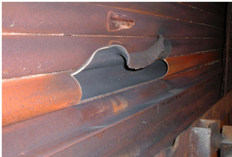
Figure 4.9: Phénomène de fluage causé par corrosion par fatigue (Éclatement d'un tube).
