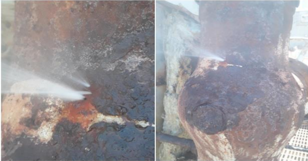
Figure 4.2 : Effet d'une corrosion par piqûre.
