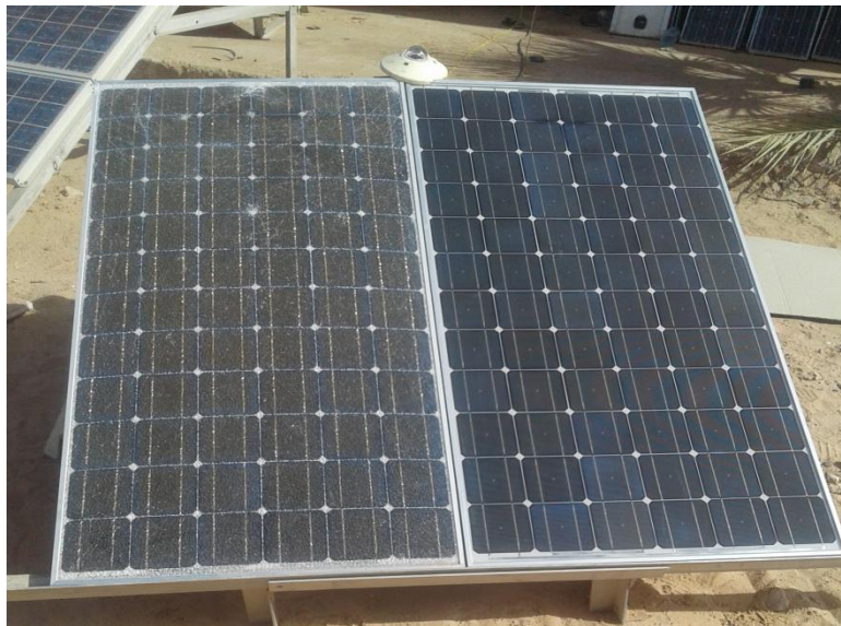
Figure III.7: Module photovoltaïque sans et avec fissure de vitre.
