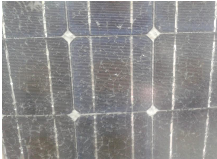
Figure II.12 : Module photovoltaïque présentant des bris de verre (modules PV UDTS50).
