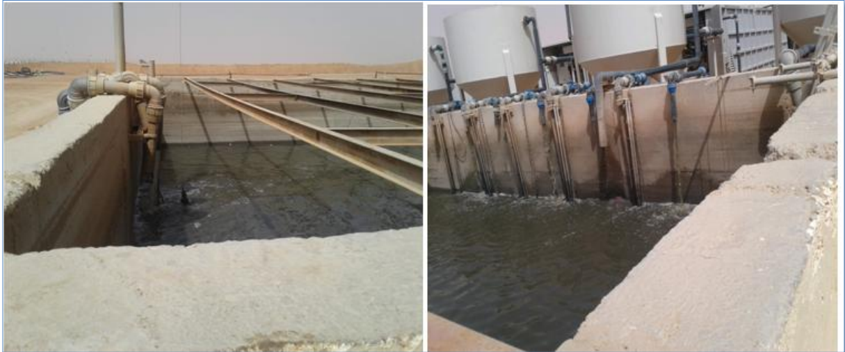
Photo III.1: Bassin d'homogénéisation de la STEP.
