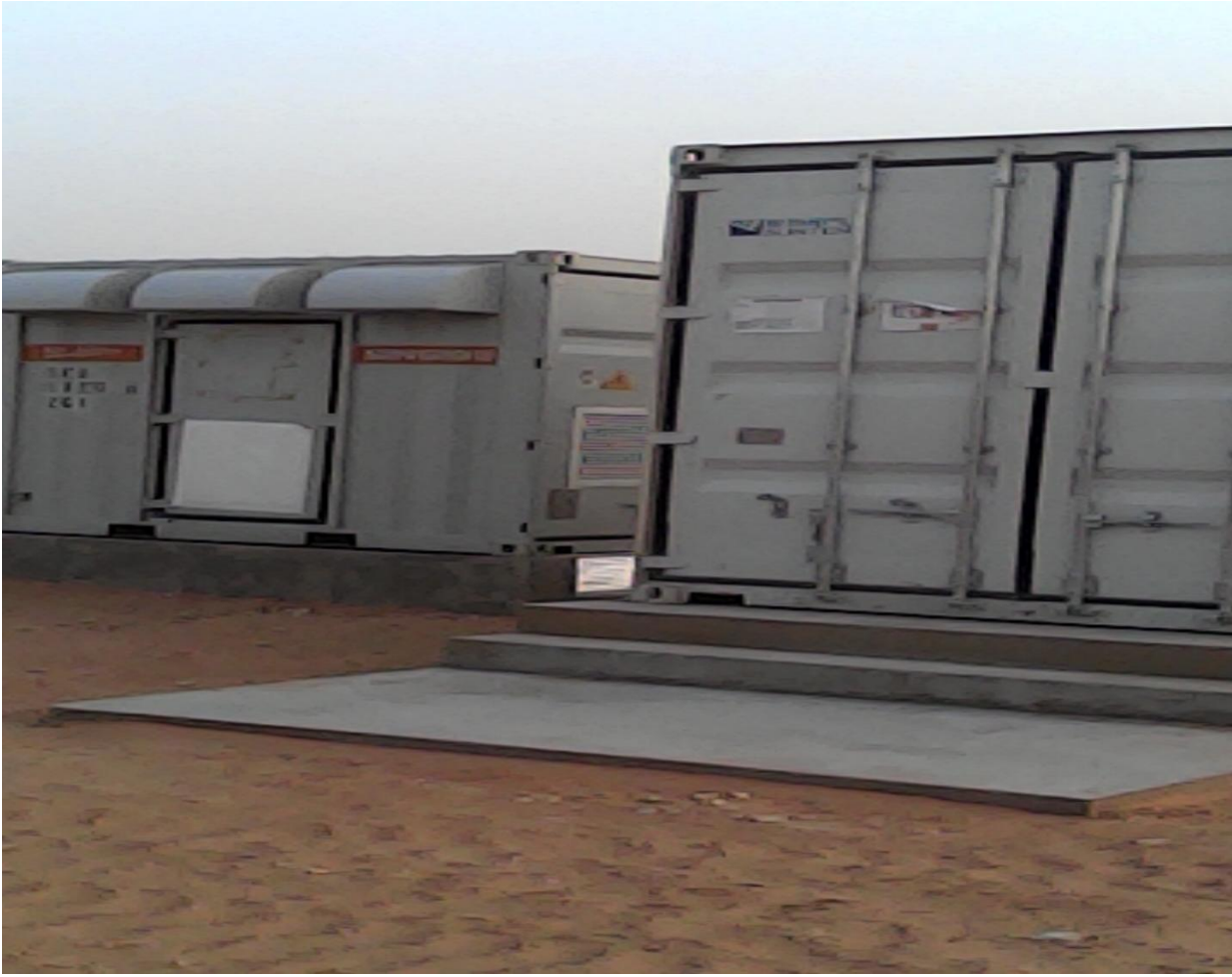
Fig III -19 Le transformateur et l' onduleur
