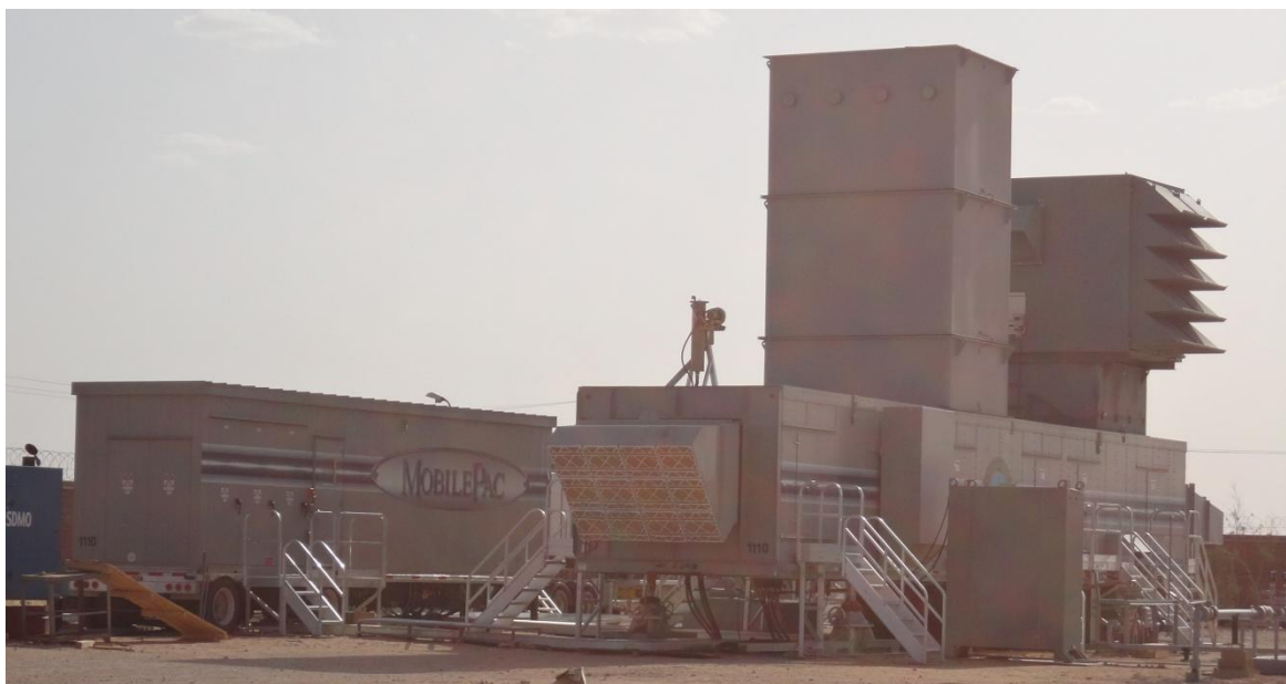
Fig III -4: Les deux modules de la Turbine.
