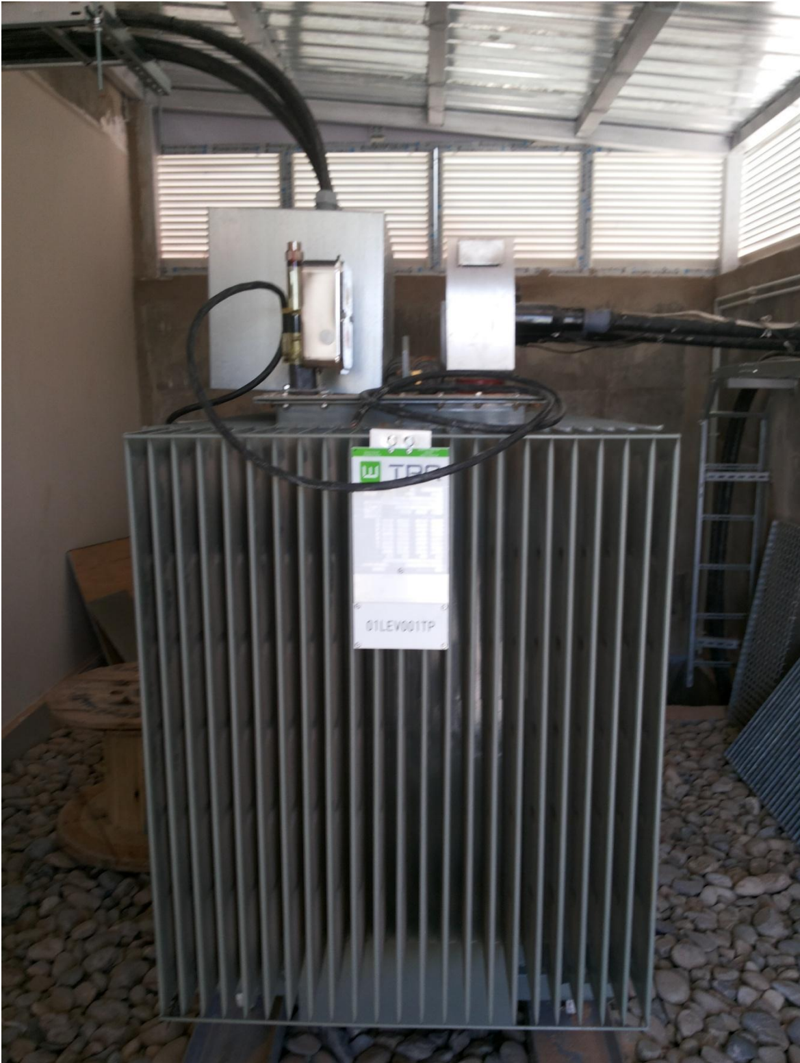
Fig III -10: -Transformateur Elévateur de Kiosque
