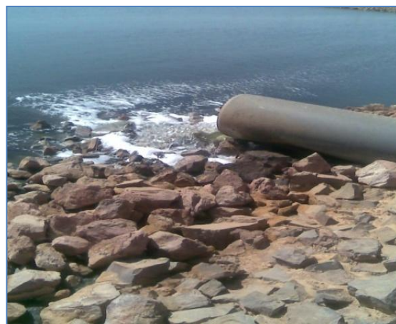
Photo N°1: Canalisation de rejet Koussane Adrar ( N. Nedjah et al, 2011 )
