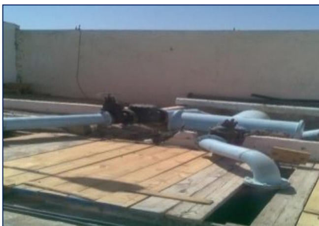
Photo N°3: Canalisations en acier (Koussane Adrar, .2016)
