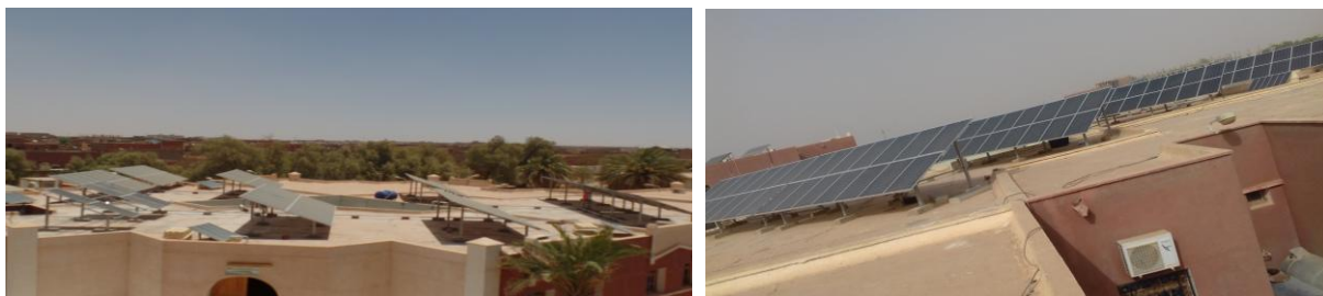
Figure IV.6 : Mini-Centrale installée au niveau de l'URER/MS
