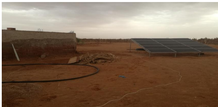
Figure IV.14 : Système de pompage PV installé à Titaf (Commune de Temest)
