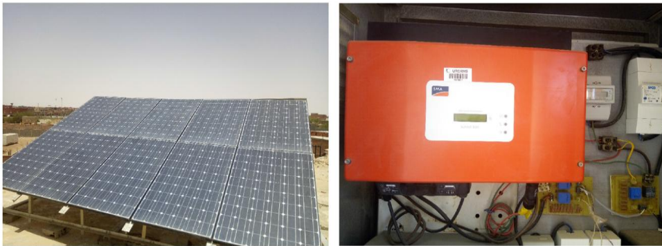
Figure IV.5 : Centrale installée au niveau de l'URER/MS
