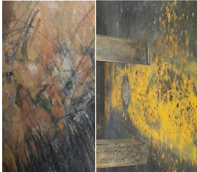
Figure 26 : Corrosion par composé de sulfurés (dessaleur)
