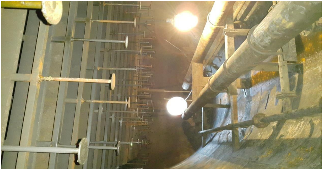
Figure 23:La zone corrodée (dessaleur)
