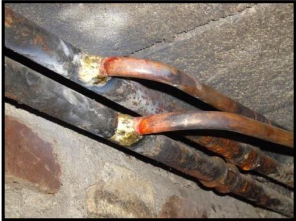
Figure 11:Corrosion chimique: Cuivre et acier noir dans une installation
