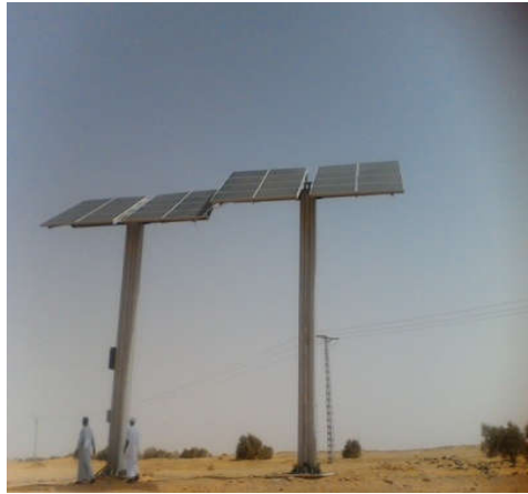
Fig.II.8: Système situé dans le site Ait Messaoud.
