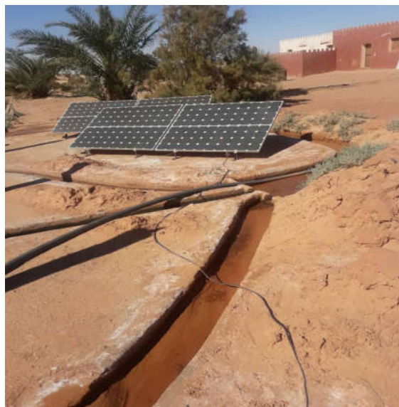
Fig. II.9: Système situé dans le site Amguid-Tamentit
