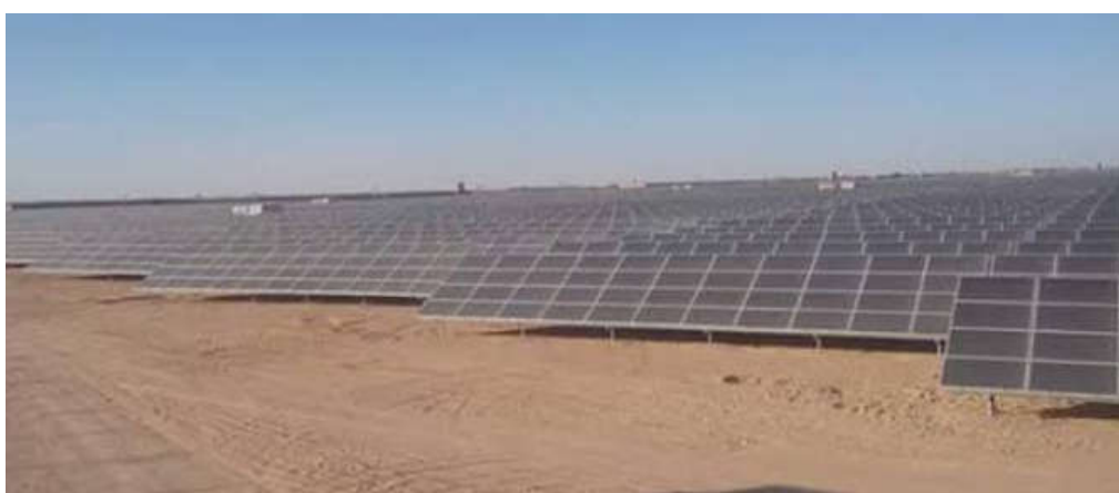
Fig.II.4 : La nouvelle centrale photovoltaïque pilote d'une capacité de 30 kilowatts
