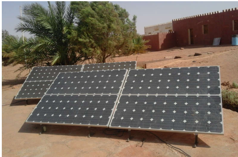
Fig II.12: Panneaux solaires photovoltaïques poly cristallin
