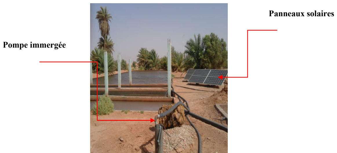
Fig. II.10: Le système complet de pompage solaire (05/02/2019).
