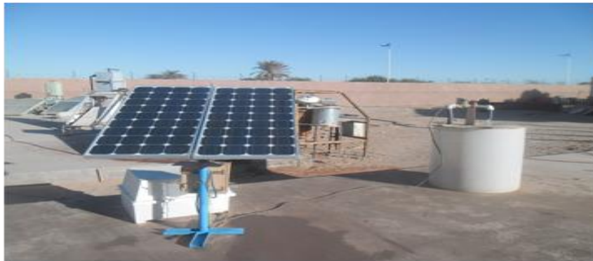
Figure III.2 : Photos du système de pompage Photovoltaïque installé à URER/MS
