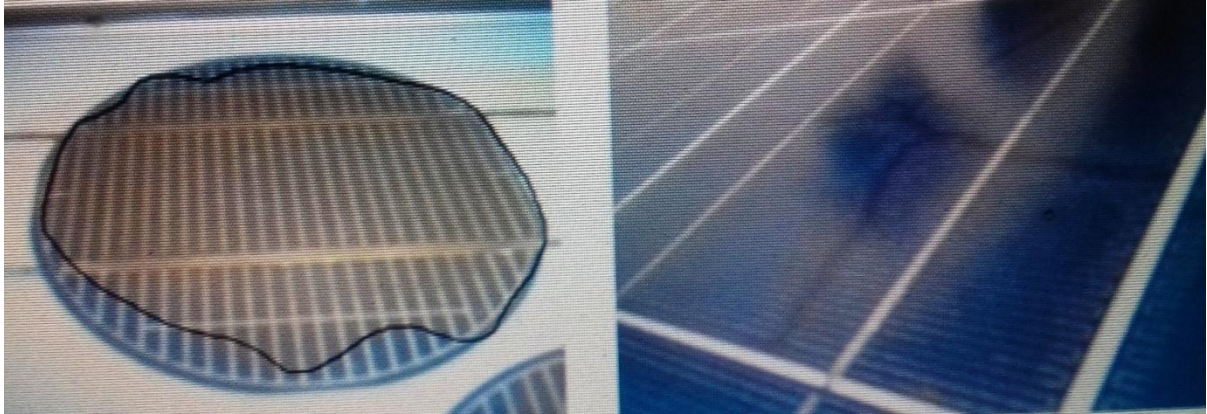
Figure III-1: Modules photovoltaïques avec des cellules décolorées.
