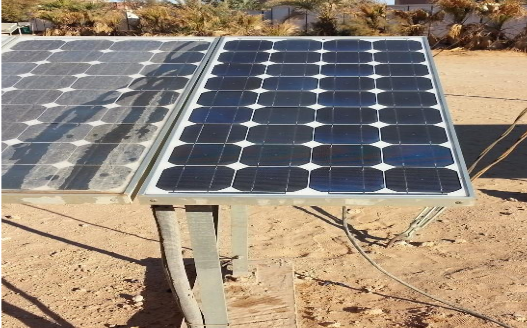
Figure IV. 13: Module photovoltaïque installé dans l'unité de recherche en énergies renouvelables dans le milieu saharien, Adrar
