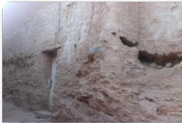
Photo 27 : Décrépissement des murs extérieurs par abandon de l'opération d'enduisage régulière
