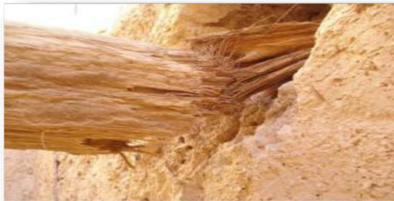
Photo 22 : Rupture d'une poutre par attaque d'insectes
