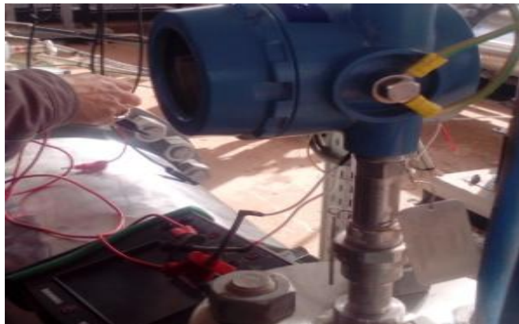
Fig III.10. Vérification des sondes de transmetteur de température[GRN]
