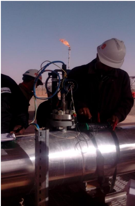
La vérification de transmetteur
