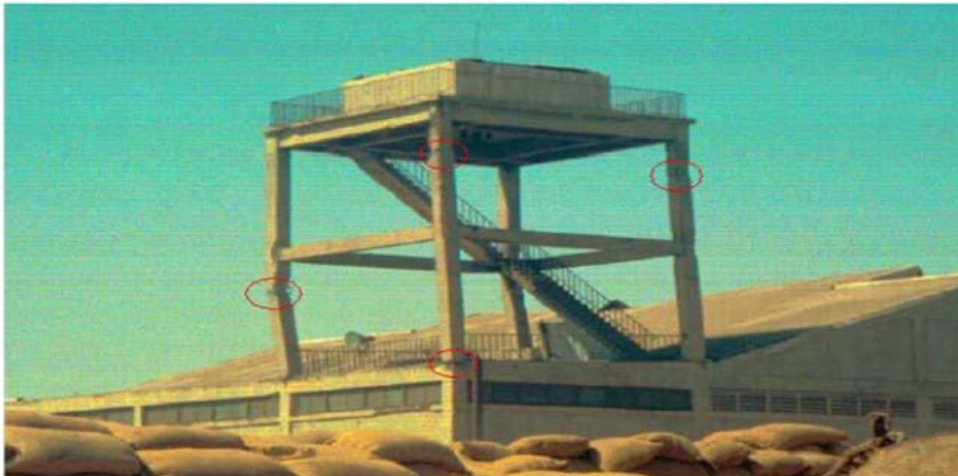
Figure I. 10 : Endommagement d'un portique à 2 étages par flexion dans les zones critiques des poteaux dans une installation portuaire lors du séisme de Buhj (Inde) en 2001 [7]. [4]
