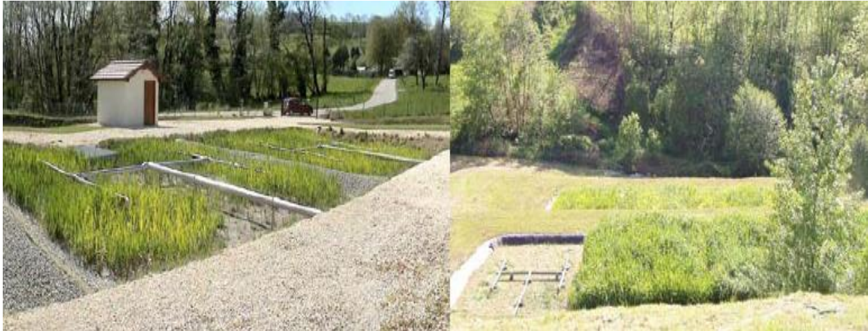
Photo 03 : Photos de réalisation de filtres plantés de roseaux (DUPONT D.,2008).
