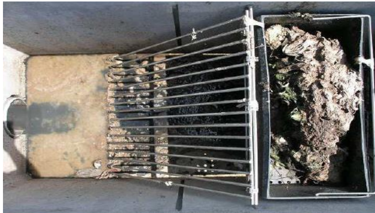
Photo 01 : Dégrillage (BOUTIN C. et al.,2015).
