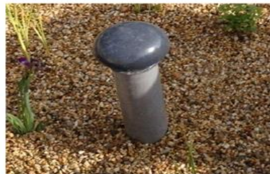
Photo 06 : Photo d'une cheminée d'aération sur un filtre vertical dans une STEP.
