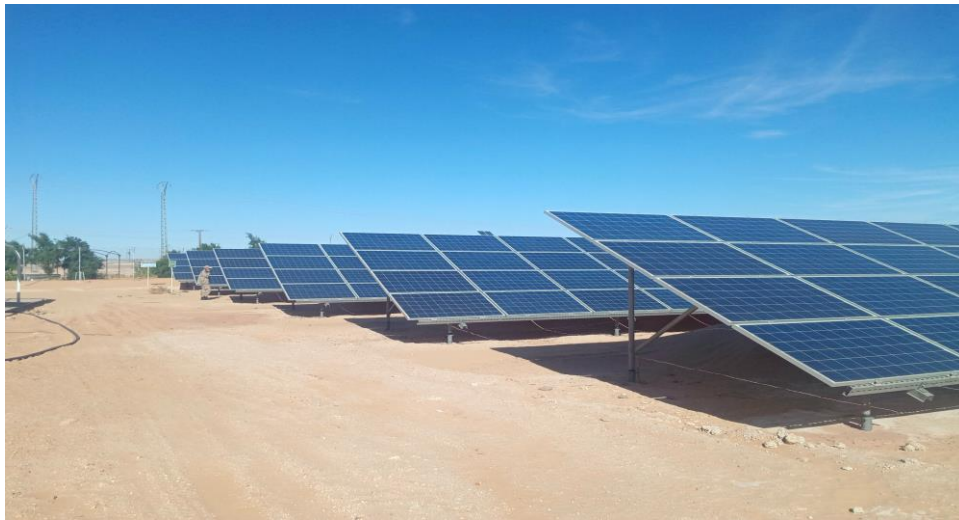
Figure III-4: La centrale photovoltaïque de kaberten
