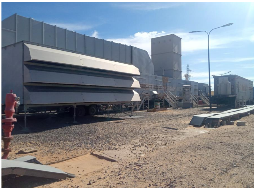
Figure III-29: turbine à gaz de stations conventionnelles de kaberten
