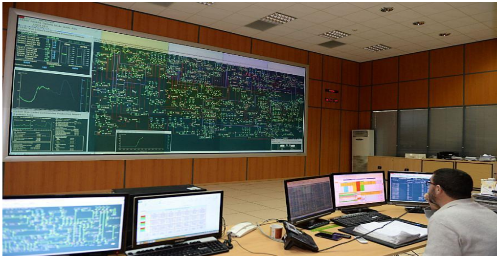
Figure II-11 : Centre de contrôle ou dispatching.
