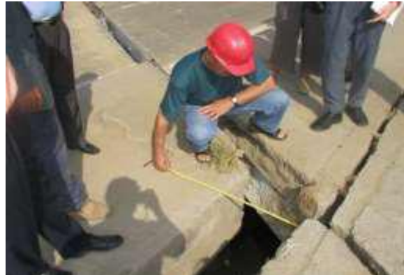
(d) Dégradation du tablier et de la culée du pot côté Heraoua[
