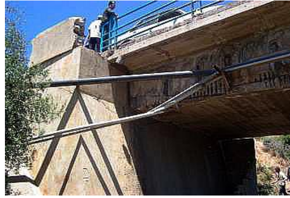
(b) Dégradation du tablier et de la culée du pot côté Heraoua[
