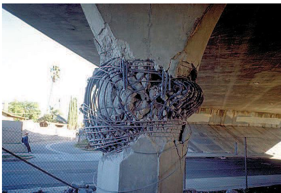
(c) Passage inférieur à l'autoroute Simi-Valley-San Fernando, Northridge (1994)
