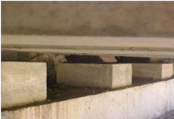
(c) Ecrasement de l'appareil d'appui et détérioration de l'appui de Pont sur Oued Sebaou
