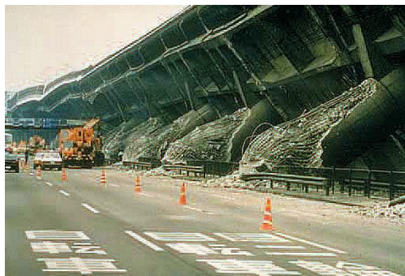
(d) Autoroute Hanshin à Kobe, Kobe (1995) (Wiki Commons).
