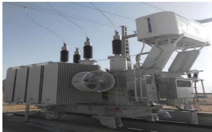
Figure II.34. Transformateur d'une station de conversion d'énergie photovoltaïque.
