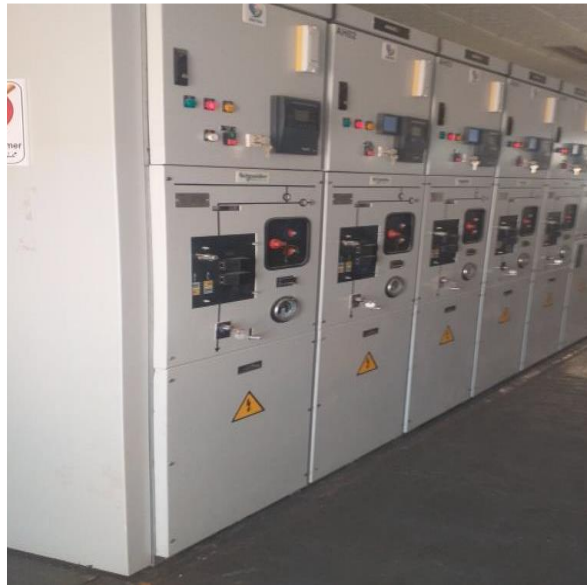
Figure II.21. Poste d'évacuation de 30 KV.
