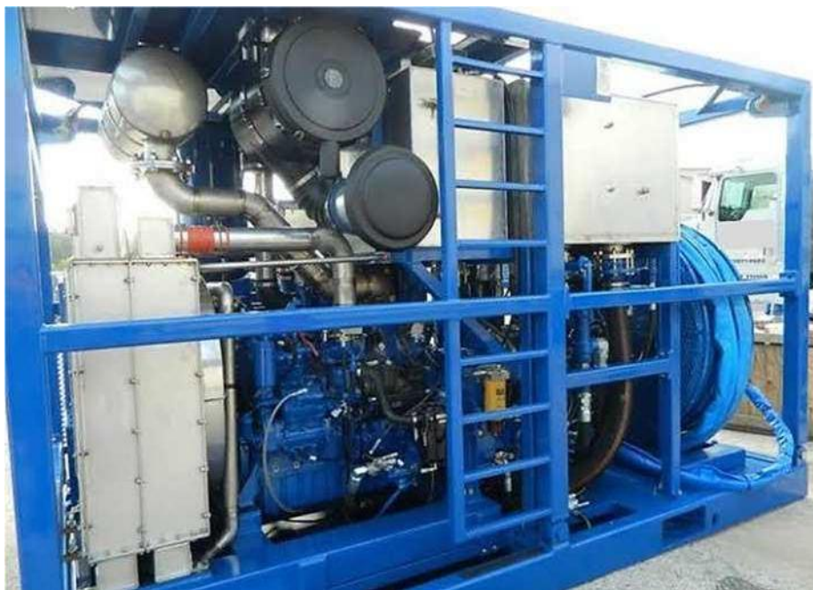
Figure 6.13 Groupe de puissance [40].
