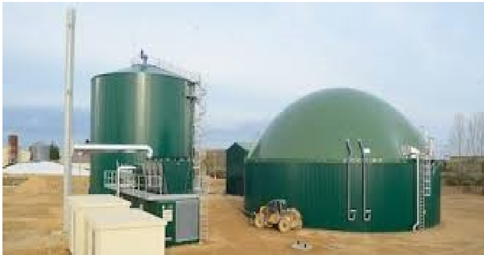
Figure IV-1: Production des biogaz par méthanisation au digesteur
